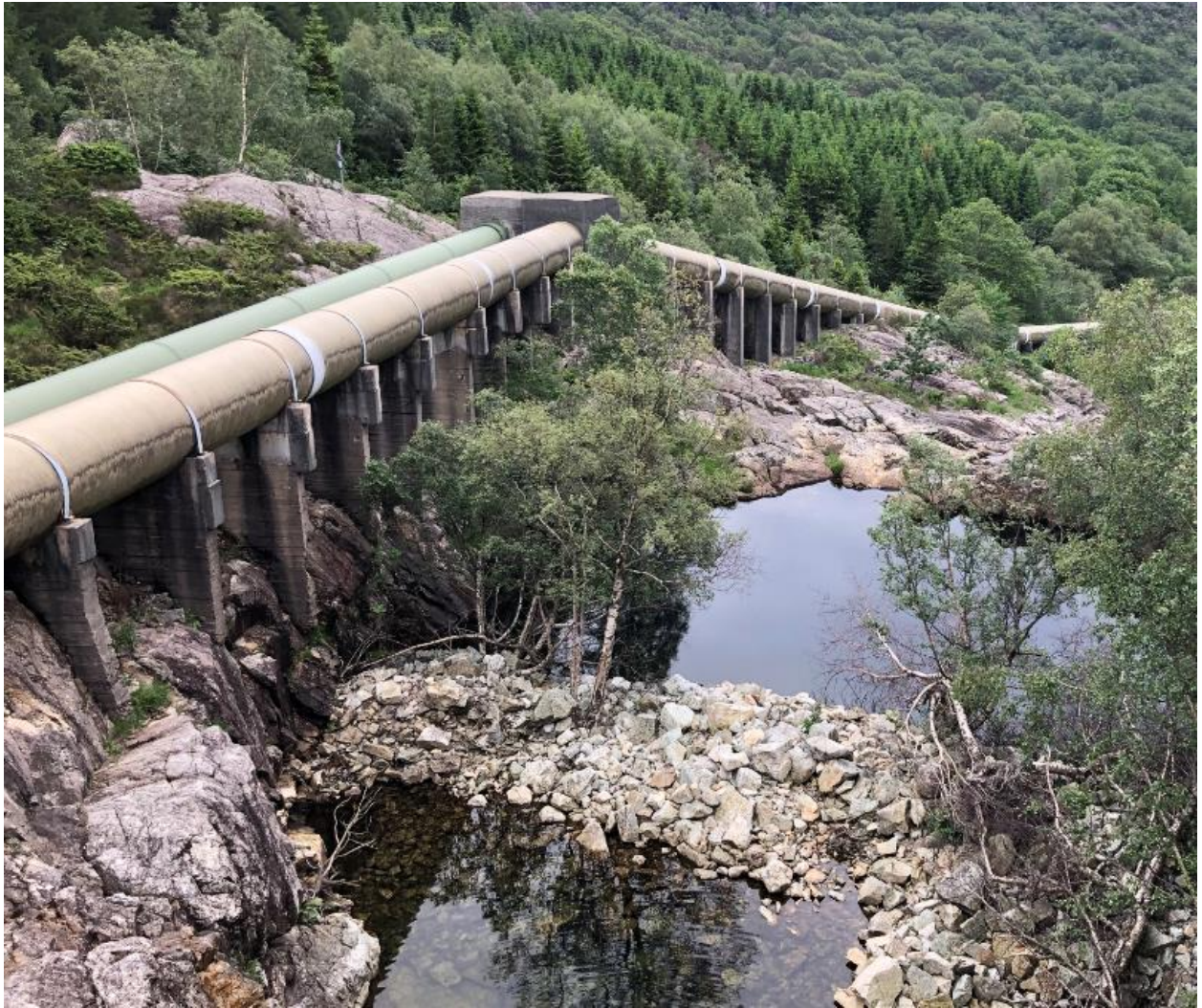
Rørgater til Grødemfoss kraftverk (fjernes med nytt kraftverk). Bekkefare nedstrøms dammen kun med noe stillestående vann i to kulper. Denne strekningen vil få en vannføring med det nye kraftverket.
