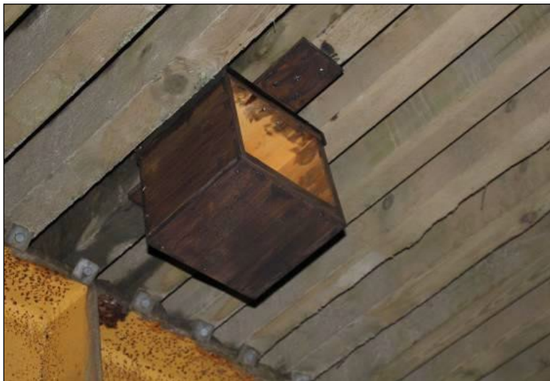
Figur 1. Eksempel på montert hekkedasse under bro
