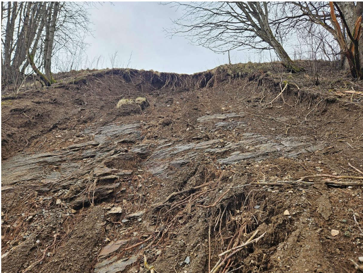
Figur 11: Løsneområdet for jordskred viser at skredet har gått helt ned til fjell.
