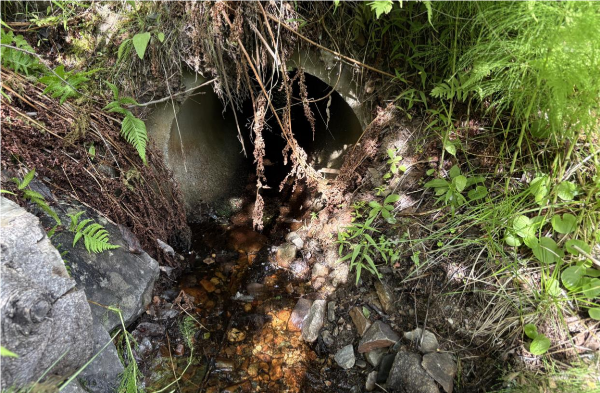
Bilde 2: Infopunkt 1 i Vedlegg 4. Bekk som går under veien. Røret er ca. 0,5 m i diameter.
