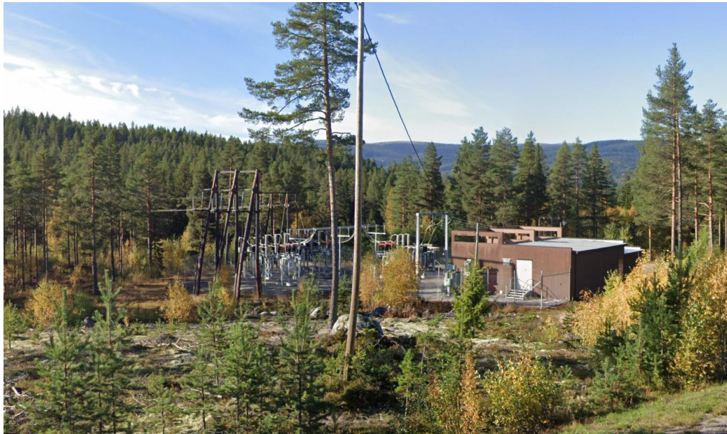
Figur 9 Koppang transformatorstasjon (Kilde: Aneo AS)
