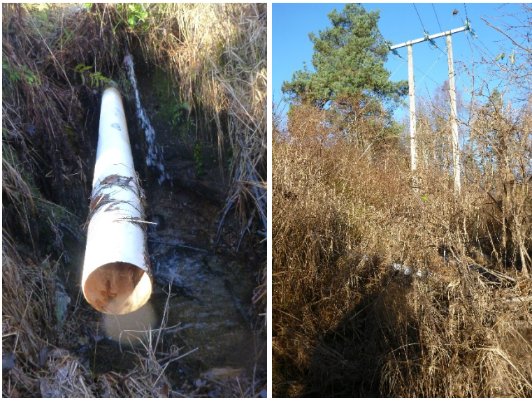
Figur 4: Erosjon rundt avløpsrør (t.v.), samt beliggenhet i skråningen (t.h.)
