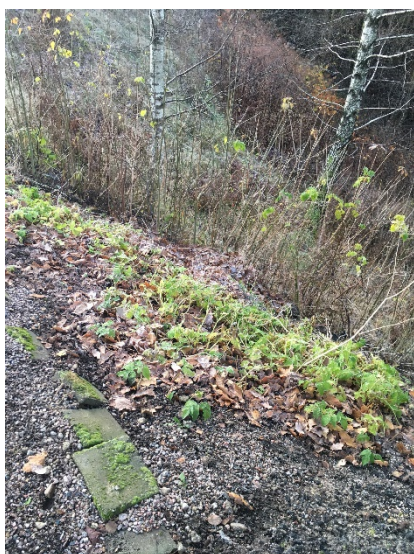
Figur 2: Område med nedsunken skråningskant. Svært bratt skråning ned til bekken.
