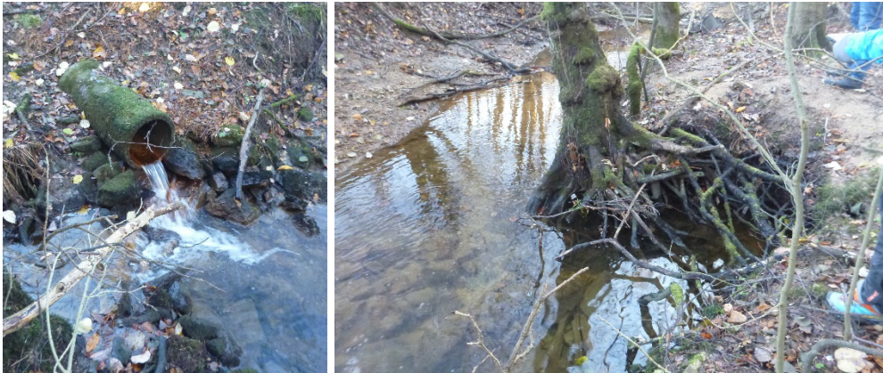
Figur 3: Erosjon fra avløpsrør (t.v.) inn i bekkekant (t.h.)
