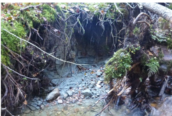
Figur 8: Erosjon i Knarrestadbekken.
