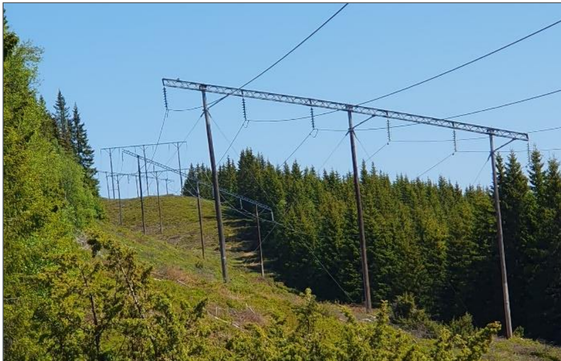
Figur 4-8: Eksisterende 132 kV like sør for Venholshøgda. Ny ledning vil gå like i nedkant av disse.
