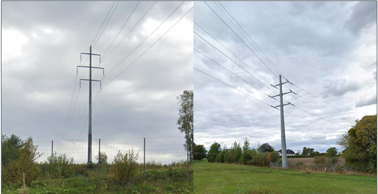
Figur 4-13: Eksempel på dobbelkursmast med vertikaloppheng (høyre bilde viser en noe kraftigere vinkelmast). Hentet fra google streetview (Spydeberg-Tunby til venstre og Halmstad-Råde til høyre).
