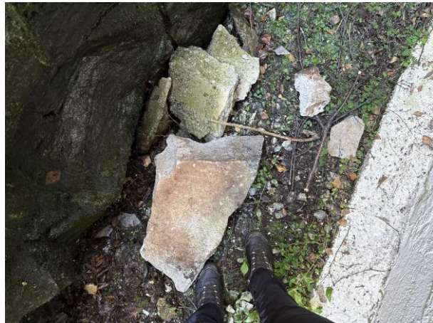
Figur 29. Steinsprangblokk langs nordsiden av bygget.
