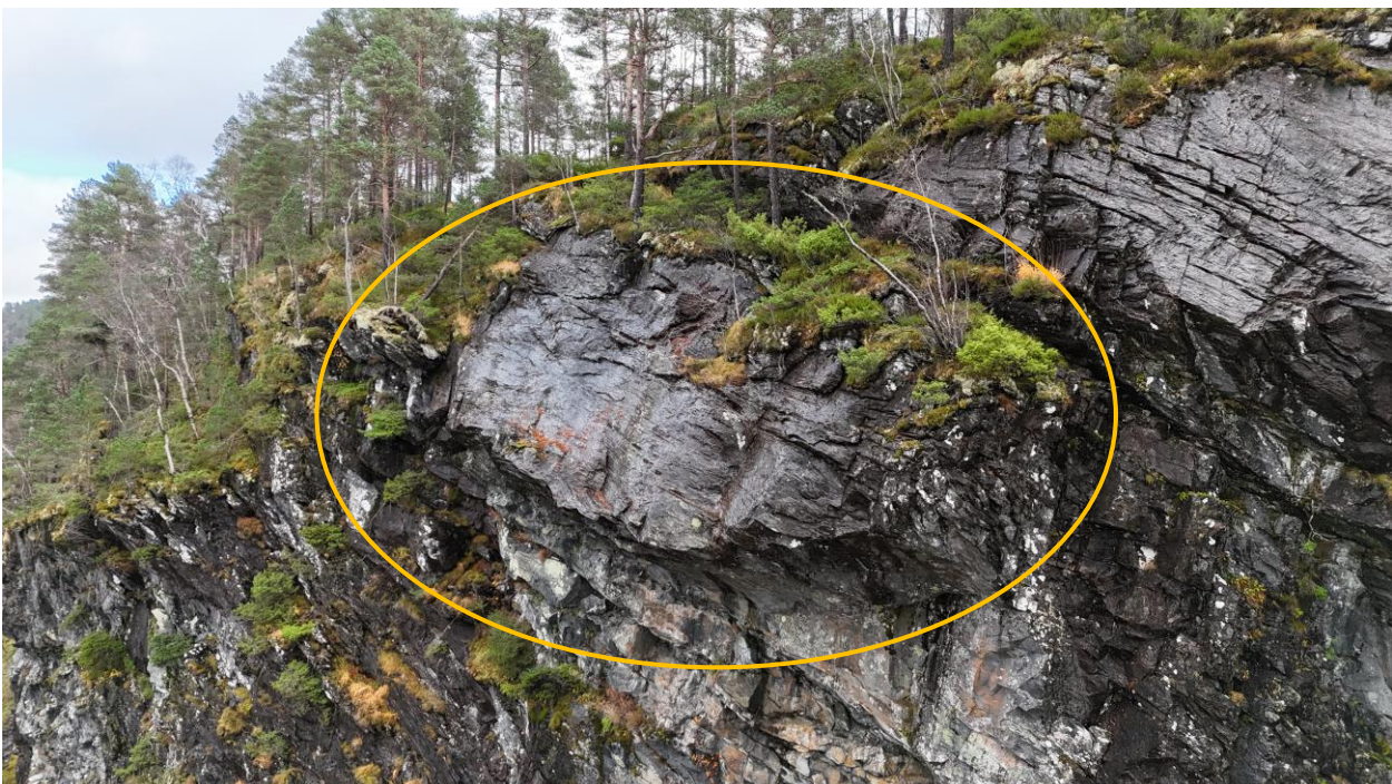
Figur 36. Overhengende bergparti med mulig baksprekk.
