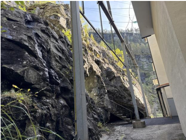
Figur 28. Kort avstand mellom skrent/skjæring og bygget.
