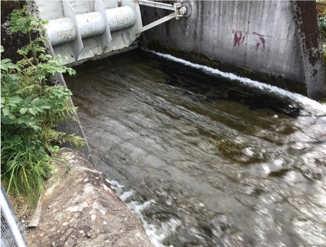
Figur 6. Når kraftverket er i drift slippes det 10,5 \text{ m}^3/\text{s} gjennom luka ut av Bjørheimsvatnet (se plassering av luka i figur 2). Dette gir en svært høy vannhastighet over den flate betongbunnen. Luka utgjør dermed et vandringsstengsel når den er stengt og et svært vanskelig vandringshinder når den er åpen (trolig stengsel).
