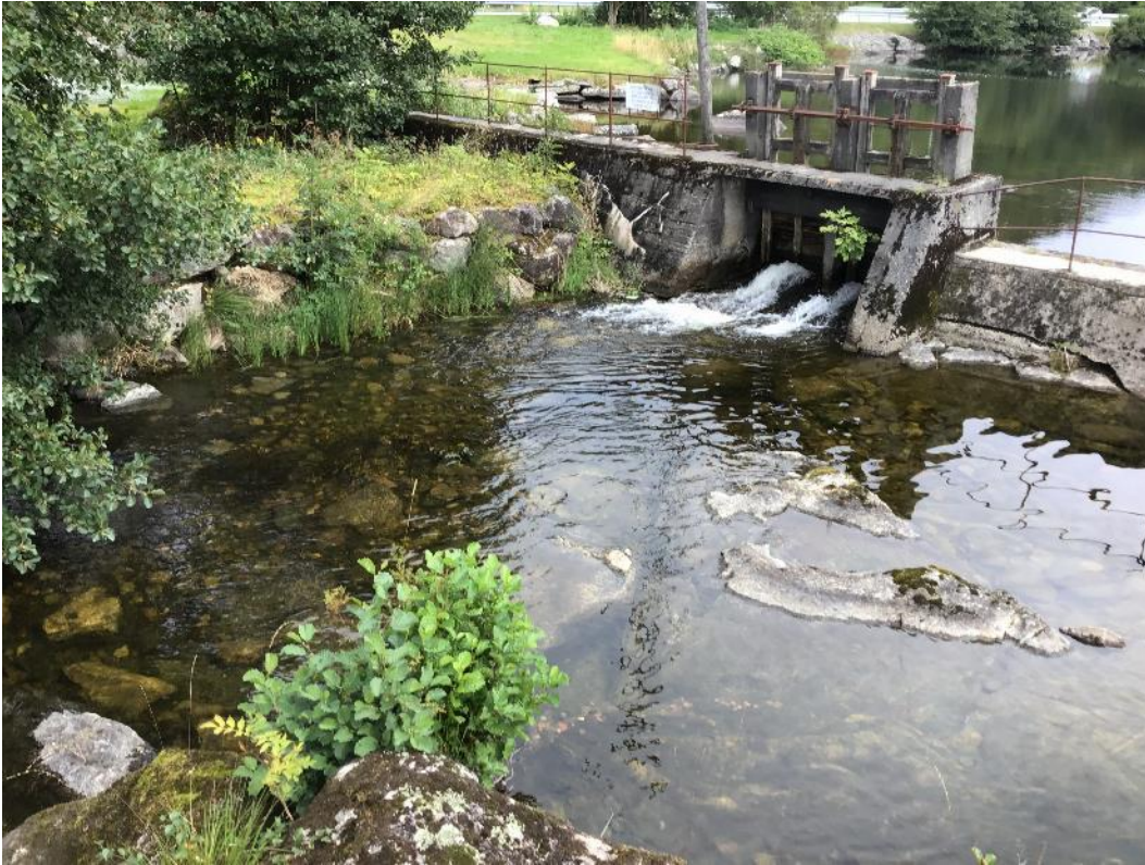
Figur 8. Treluke i nordre løp ut av Bjørheimsvatnet. Hull i lukene gjør at det nå renner 2-300 l/s gjennom luka (grovt anslag), men det er kun sluppet vann her siste år i forbindelse med forprosjektet. Det 250 m lange nordre løpet påvirkes dermed mindre ved stengning enn søndre del.
