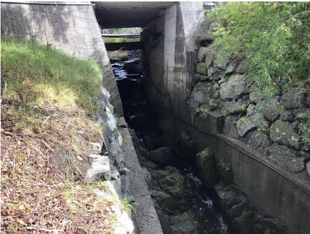
Figur 5. Flomoverløpet fra Krossvatnet, bilde tatt under Kvernvegen. Under Kvernvegen er det sprang på rundt 3 meter, med høy gradient og liten mulighet for oppstuvning av vann for sprangrop nedstrøms. Det er sannsynlig at løpet kan ha blitt bearbeidet eller endret, og at anadrom fisk tidligere kunne ta seg opp her. Overløpet er også en sannsynlig oppvandringsvei for glassål.
