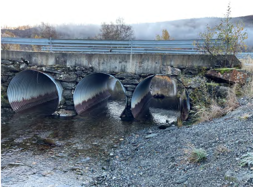
Figur 8: Kulverter i Hjartåna ved parkeringsplassen oppstrøms fylkesvegen har lite fall og er påvirket av vannstanden i Langvotnevatnet.
