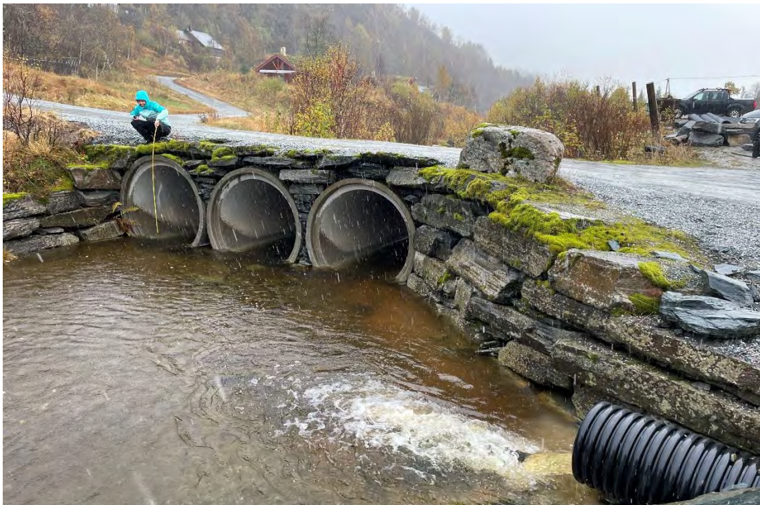
Figur 7: Kulverter i øvre del av Røyro ved Dalen er sårbare for gjentetting, spesielt vinterstid.
