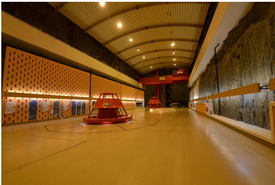
Figur 4.1 Maskinsal Svartisen kraftverk
