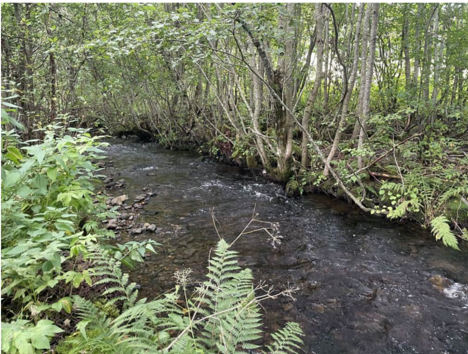
Figur 3-6: Punkt U5. Ulkestadelva nedstrøms bruene over Ulkestadveien. Tegn til erosjon med fremoverbøyde trær og noe erosjonskant, men måten flere av trærne har rettet seg opp igjen, samt størrelsen på erosjonssårene tyder på at prosessene går relativt langsomt.
