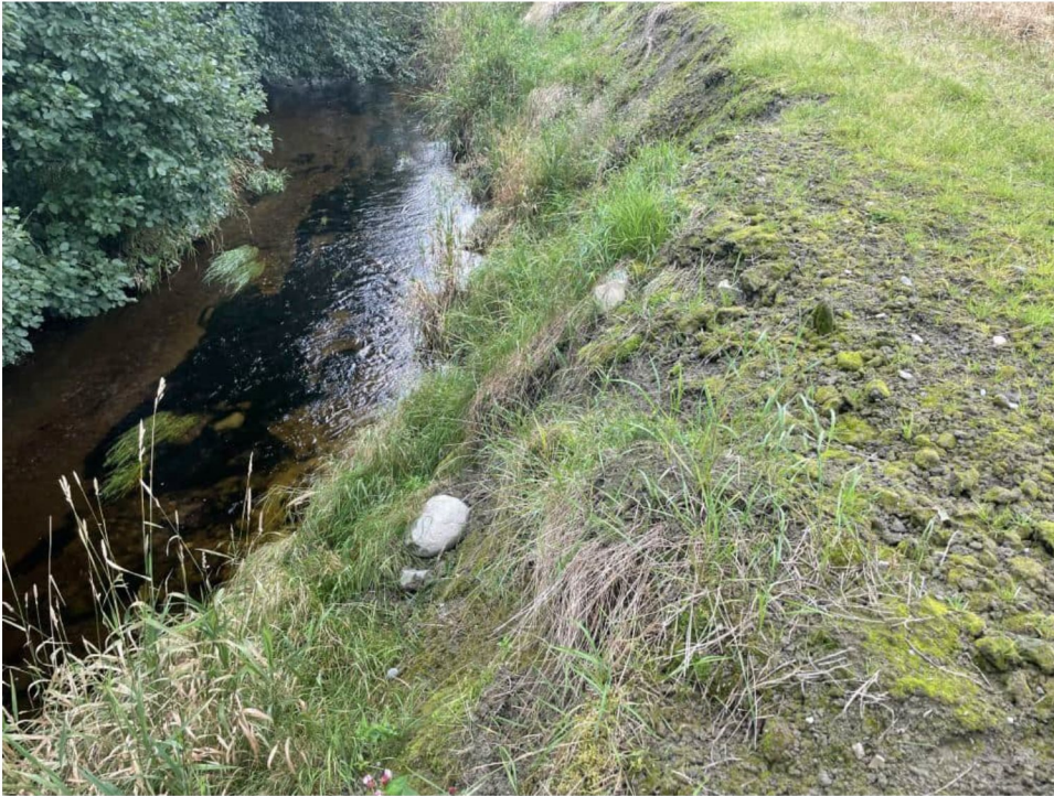
Figur 3-20: Punkt SM1. Erosjonskant i yttersving og tegn til eldre sikring.
