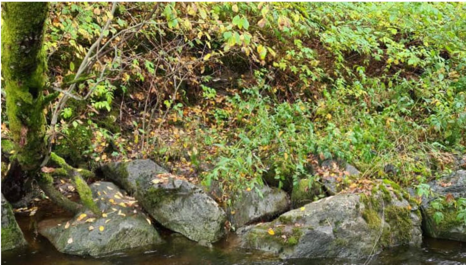
Figur 3-16: Punkt SV9. Nedenfor eiendom Tolla 1. Eksisterende sikring ligger et stykke ut i elva. Høy erosjonskant i bakkant av sikring med stor stein.
