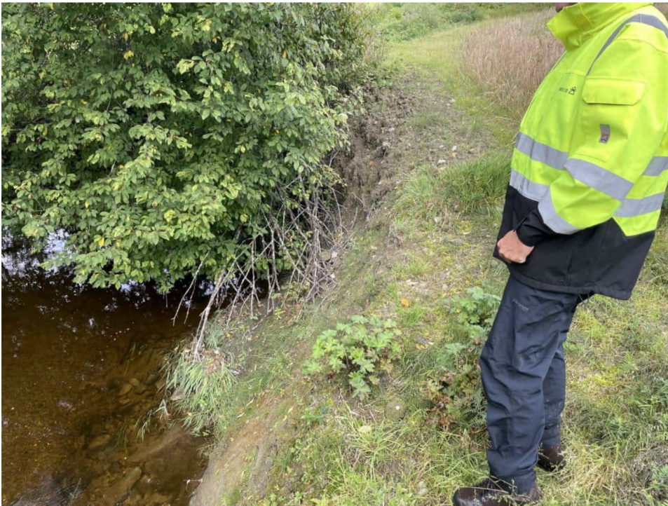
Figur 3-14: Punkt SV7. Erosjonskant. Man ser tydelig på kanten mot jordet, som er blitt ujevn, at utglidning har funnet sted. I dette området mangler det kantvegetasjon. Bilde tatt på nordsiden av elva.
