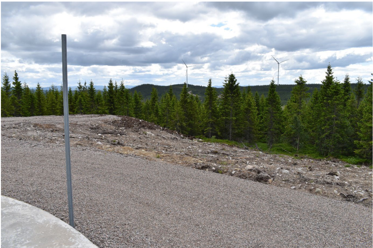
Figur 46. T8, turbinpunkt mot sør. I denne skråningen hadde NVE merknad om for mye grov stein i overflaten under befaring. Steinene er nå fjernet.
