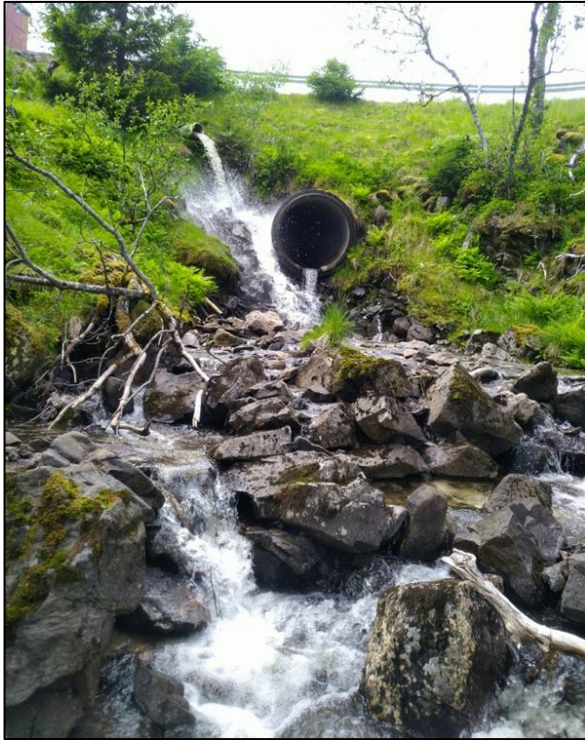
Figur 3-17 Kulverten under veien inn til vannbehandlingsanlegget er absolutt vandringshinder for anadrom fisk.
