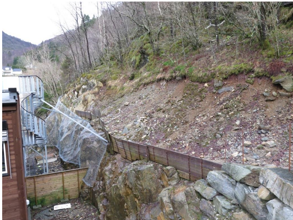
Bilde 5. Løsmasseskråning bak brakkebygg i Indre Sædal hvor eksisterende sikring bør skiftes ut.
