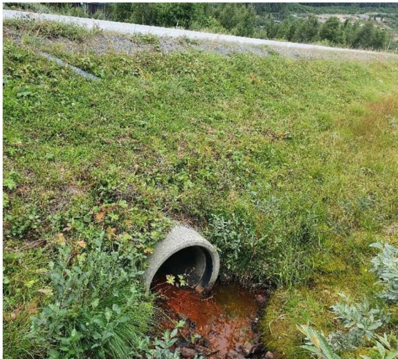
Figur 7: Stikkrenna til bekk midt under Panoramavegen. Grøfta mot høyre går mot Saubekken.
