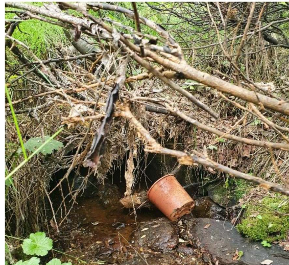
Figur 8: Stikkrenna til bekk midt rett etter Panoramavegen er delvis tilstoppet.
