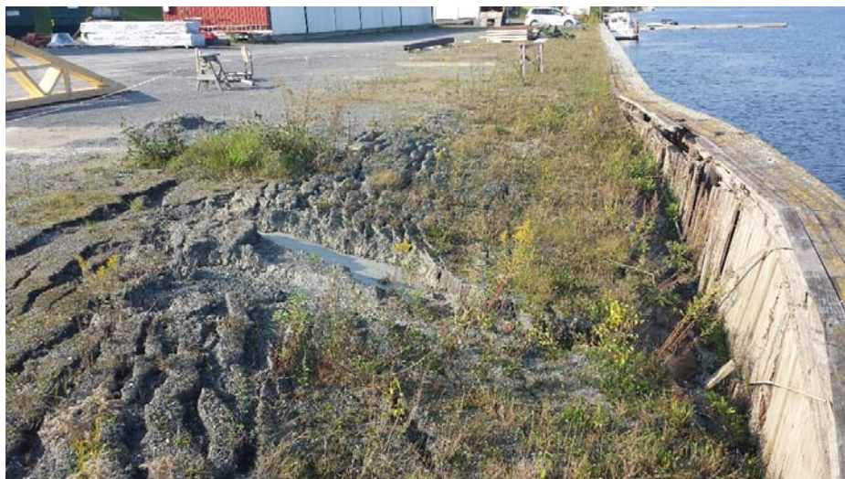
Figur 7. Skader på spuntkonstruksjonen i elvekanten, bilde fra befaringsdatoen 14.09.2016.
