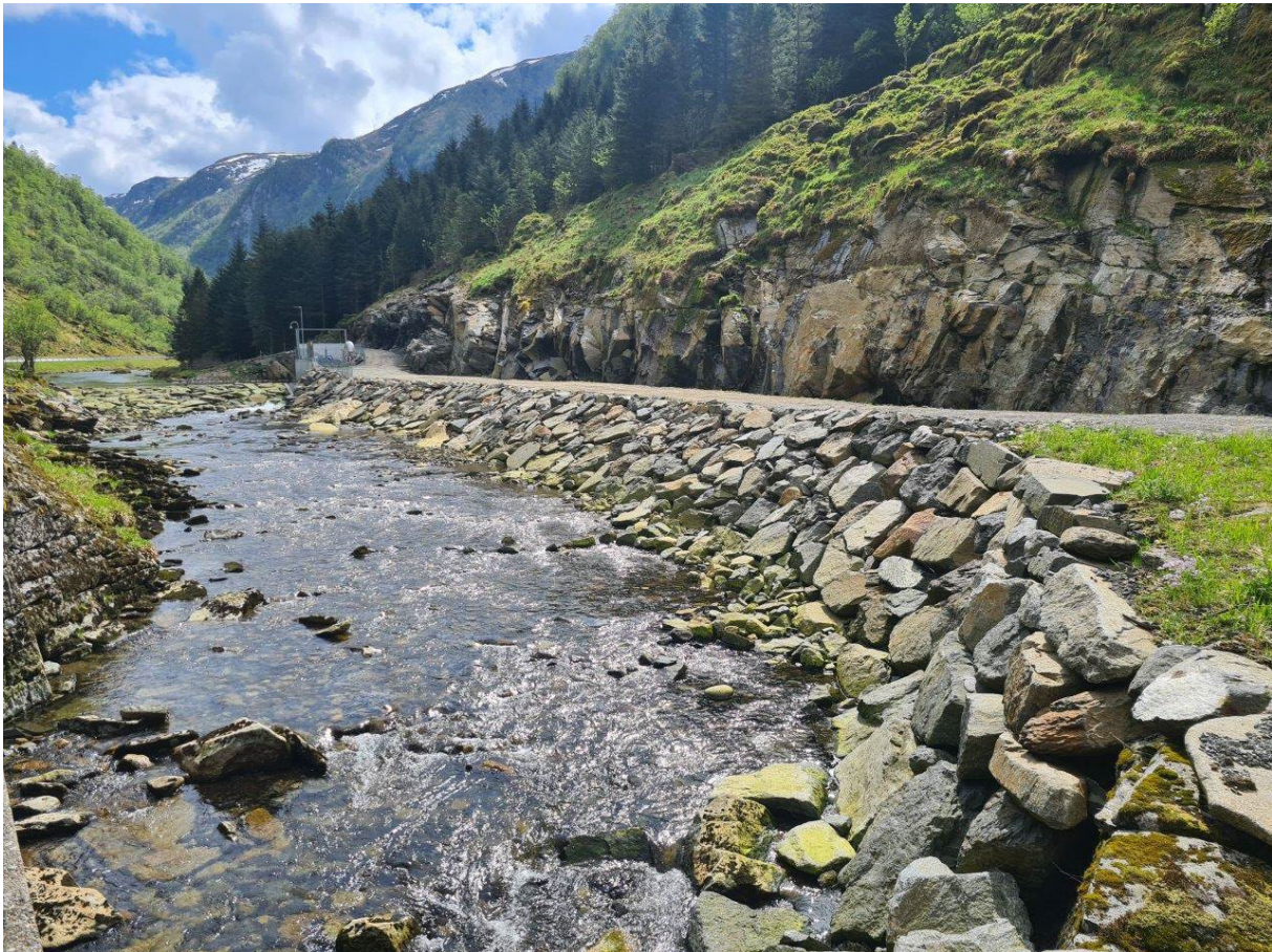
Figur 3-17 Eksempel på etablering av rørgate tett på elv fra Storelva kraftverk i Gulen kommune. I tilfellet for Øvre Ullestadåna kraftverk skal det ikke etableres permanent tilkomstvei og skråningen vil tilbakeføres og tilpasses mot veiskråning opp mot fylkesvei.
