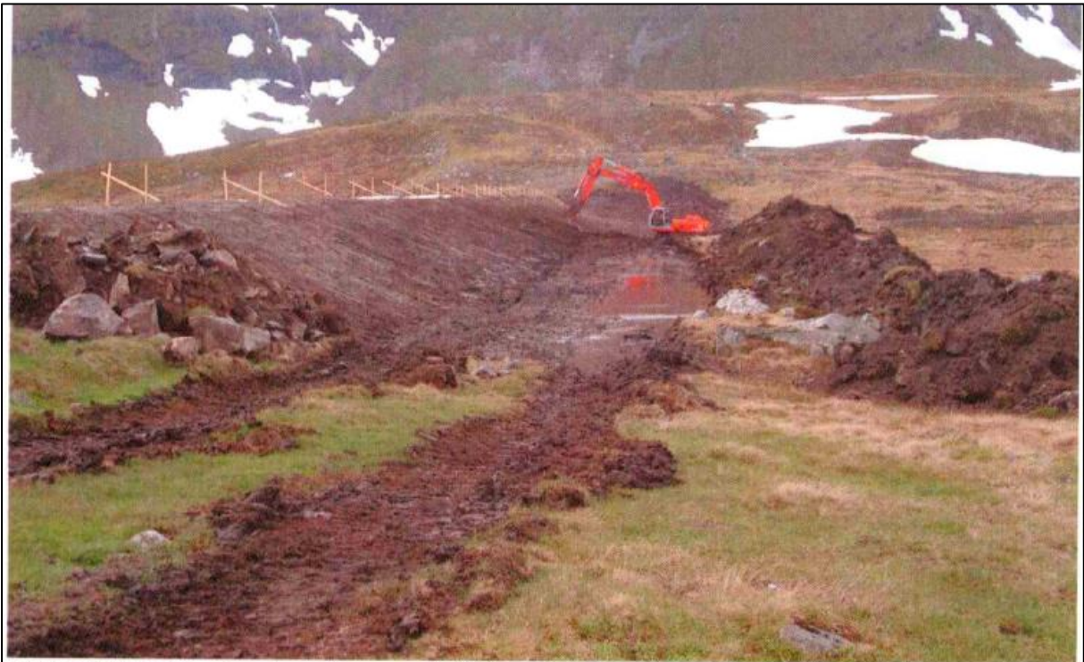
23.06.2003. Graving i nedstrøms skråning mot vestenden av dammen.
