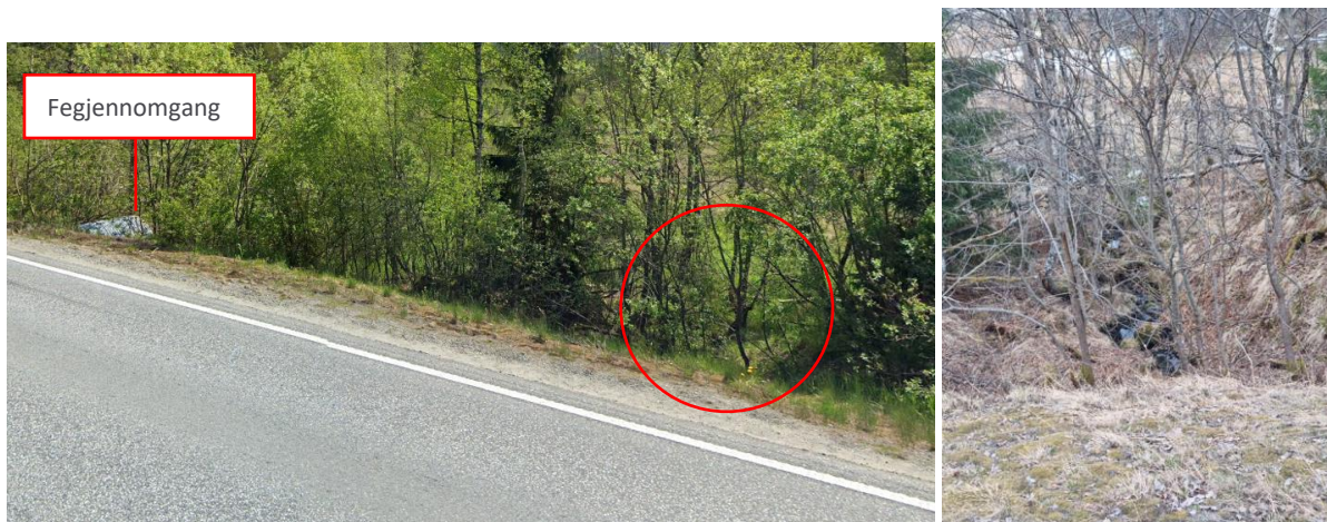
Figur 2.16 Antatt stikkrenne, ca. profil 270 (Google maps, juni 2023) og avrenning i antatt utløp (SVV)
