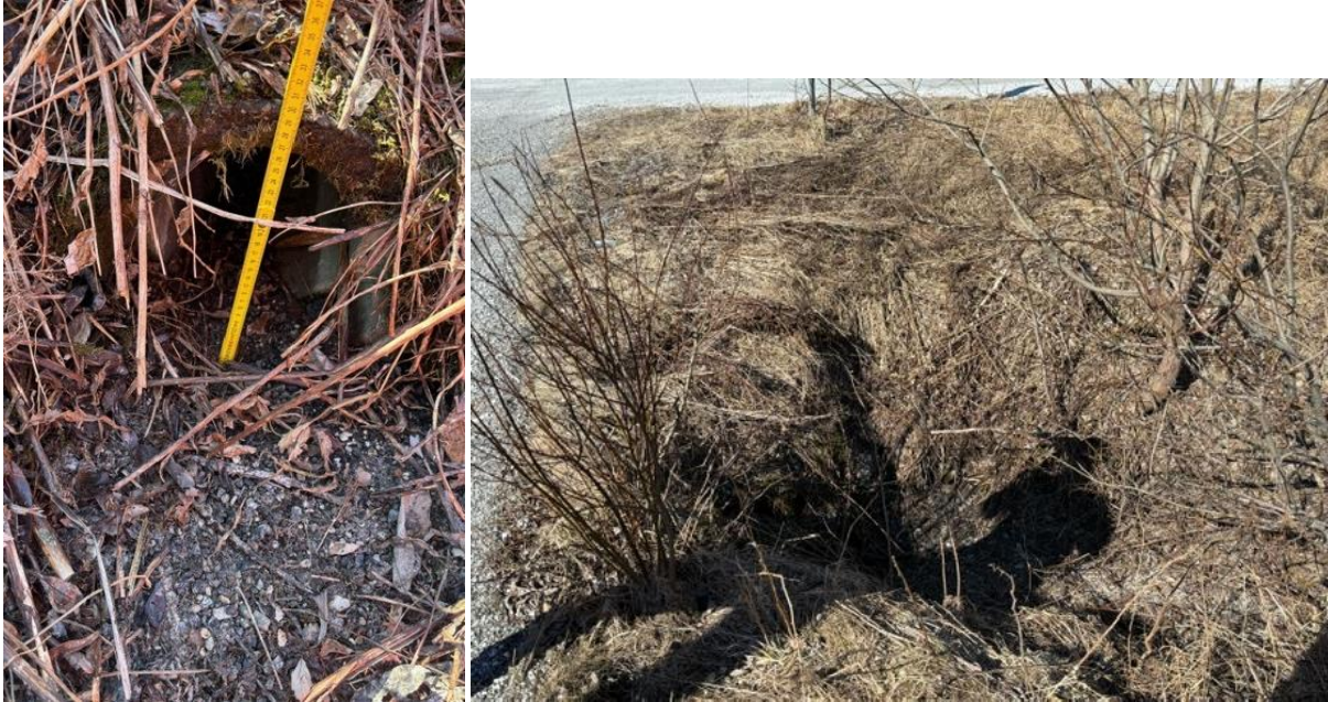
Figur 2.9 Bilde av stikkrenne \varnothing 250 mm og terreng rundt, ca. profil 850. Uklar fallretning. Utløp antas i kum (SVV)
