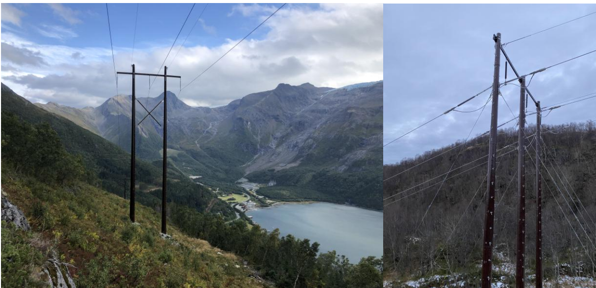
Figur 2-7. Venstre: bilde av H-mast. Høyde: bilde av H3-mast med barduner. Det er ikke avklart om H3-mastene i dette prosjektet vil ha bardunering. Foto: Norconsult.
