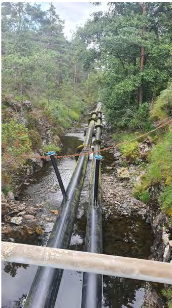
Figur 1-6: Foto av de to eksisterende rørene som går fra Håvikvatnet til stamfiskeanlegget. Foto: COWI
