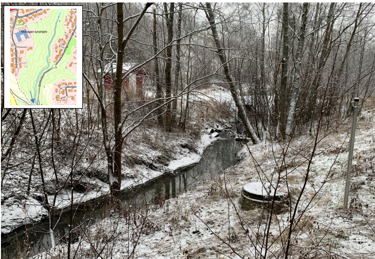
Figur 10 «Litt» erosjon fra befarings 30.11.21
