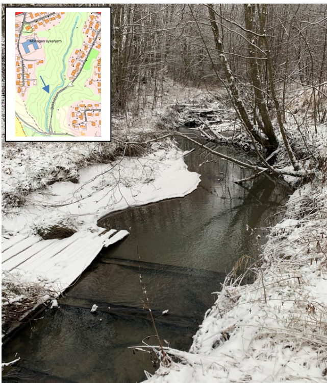
Figur 8 - «Litt» erosjon fra befarings 30.11.21
