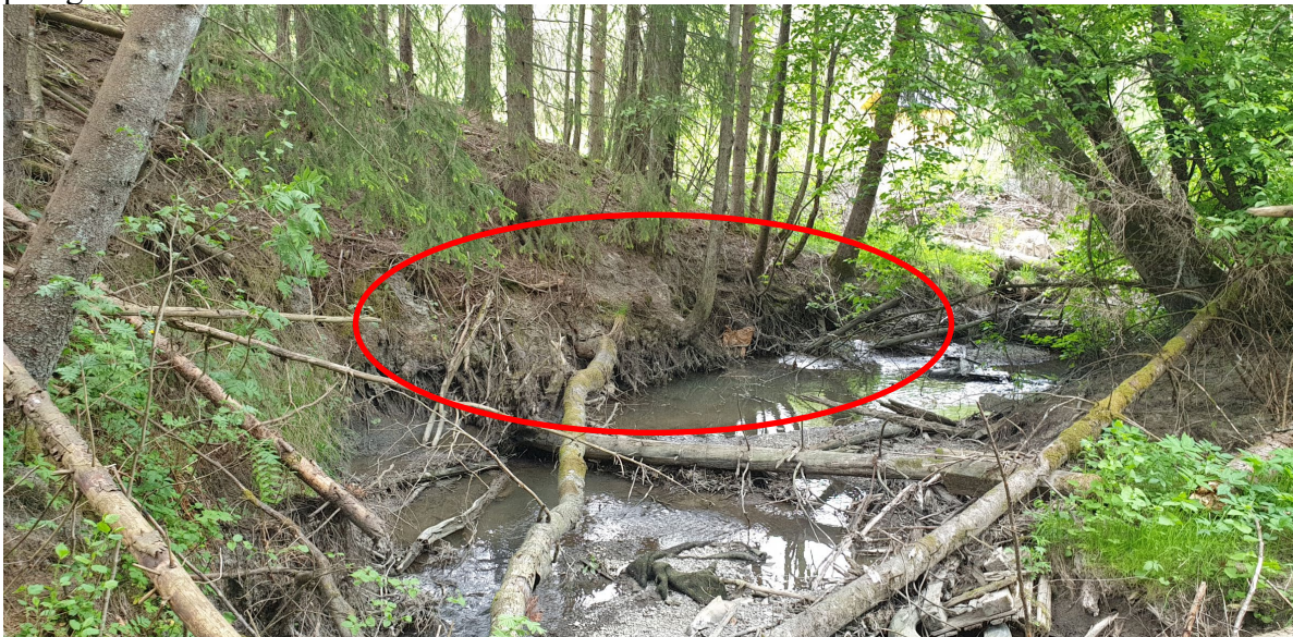
Figur 11 «Noe» erosjon, nord i område 2 - Foto fra befaring 27.05.2020.
