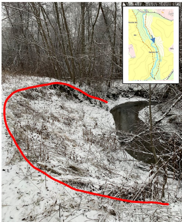
Figur 16 «Noe» erosjon – befaring 30.11.2021
