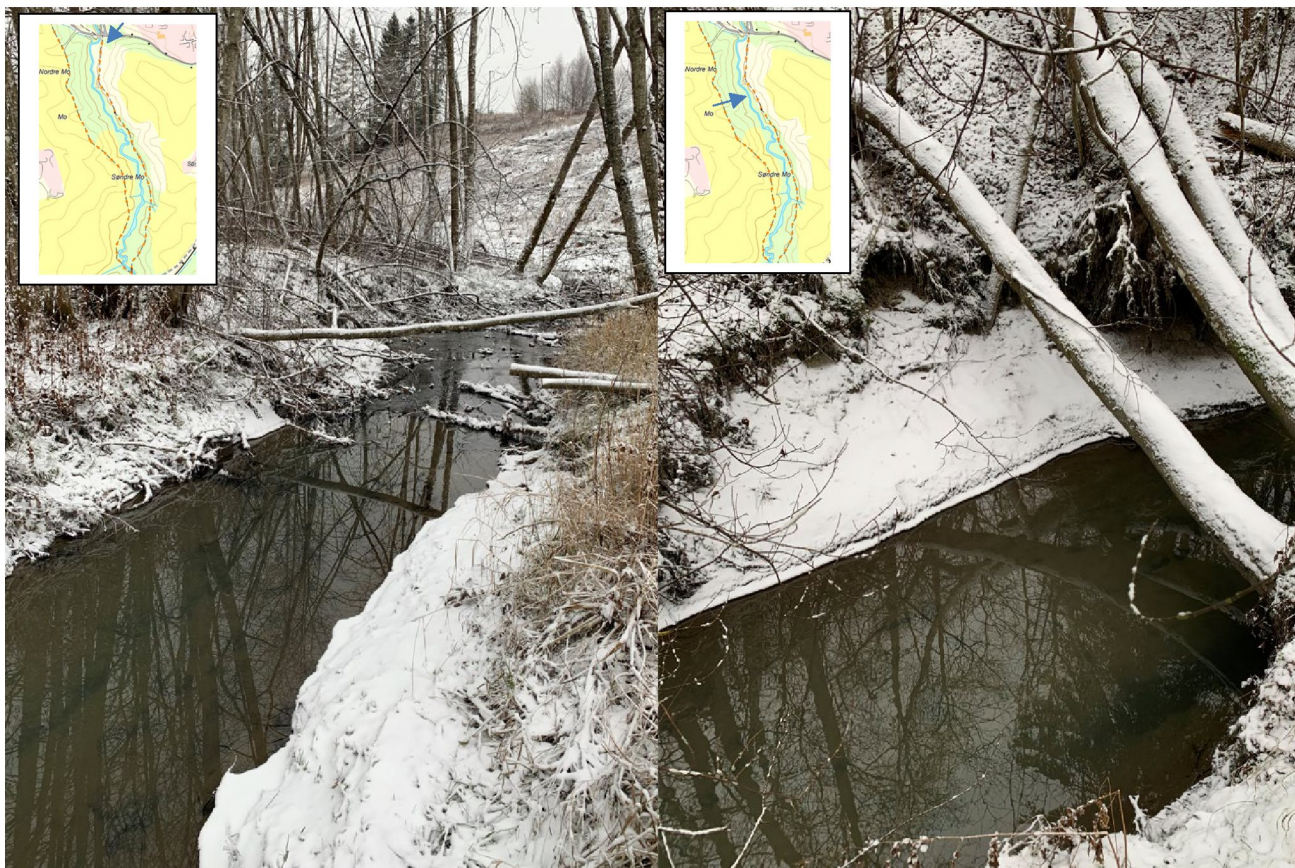
Figur 13 «Litt» erosjon – befaring 30.11.2021
