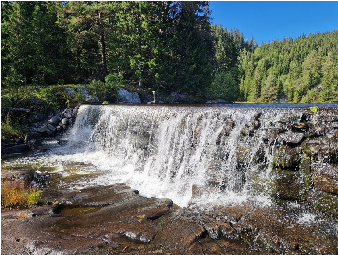
Figur 7 Biletet gjev eit inntrykk av høgden på dammen. Om lagt midt på, kan ein sjå rattstammen som er knyttet til tappeluka, men sjølv rattet er løsna, og ligg ved siden av
