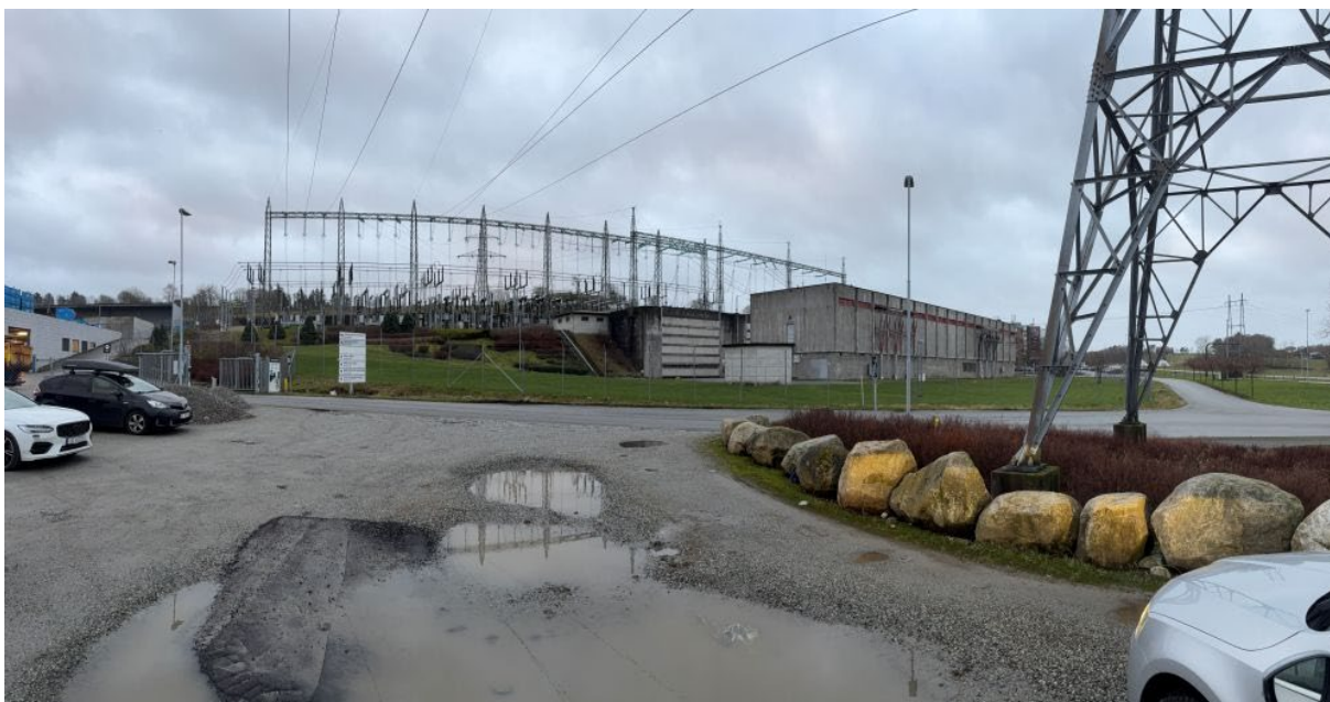
Figur 21 Eksisterende Bærheim transformatorstasjon sett fra opparbeidet areal nord for stasjon. Bildet er tatt i desember 2025.
