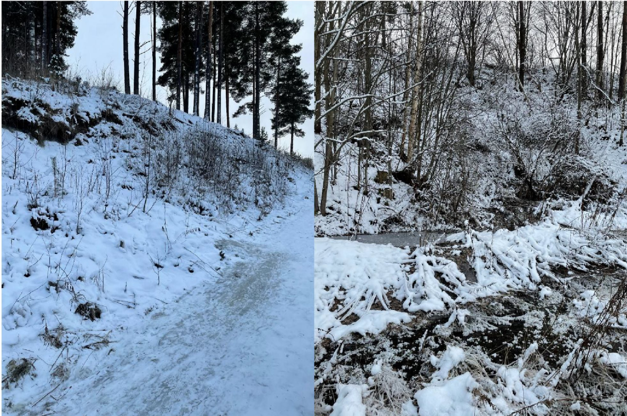
Figur 2. Bildet til venstre anleggsvei ned fra Frydenhaugen 6. Bildet til høyre viser vannansamling på nedsiden av anleggsveien (kilde: Ringerike kommune)
