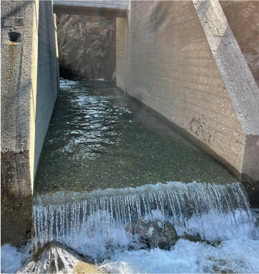
Figur 10: Inntak Jonstølåna 29. august 2021
