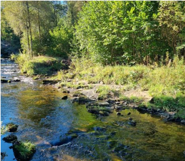
Bilde 4: På denne strekningen var det tidligere en plastring/mindre tørrmur, som nå er erodert bort.
