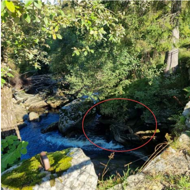
Bilde 1: Erosjon ved bru ved Øvrehagen.
