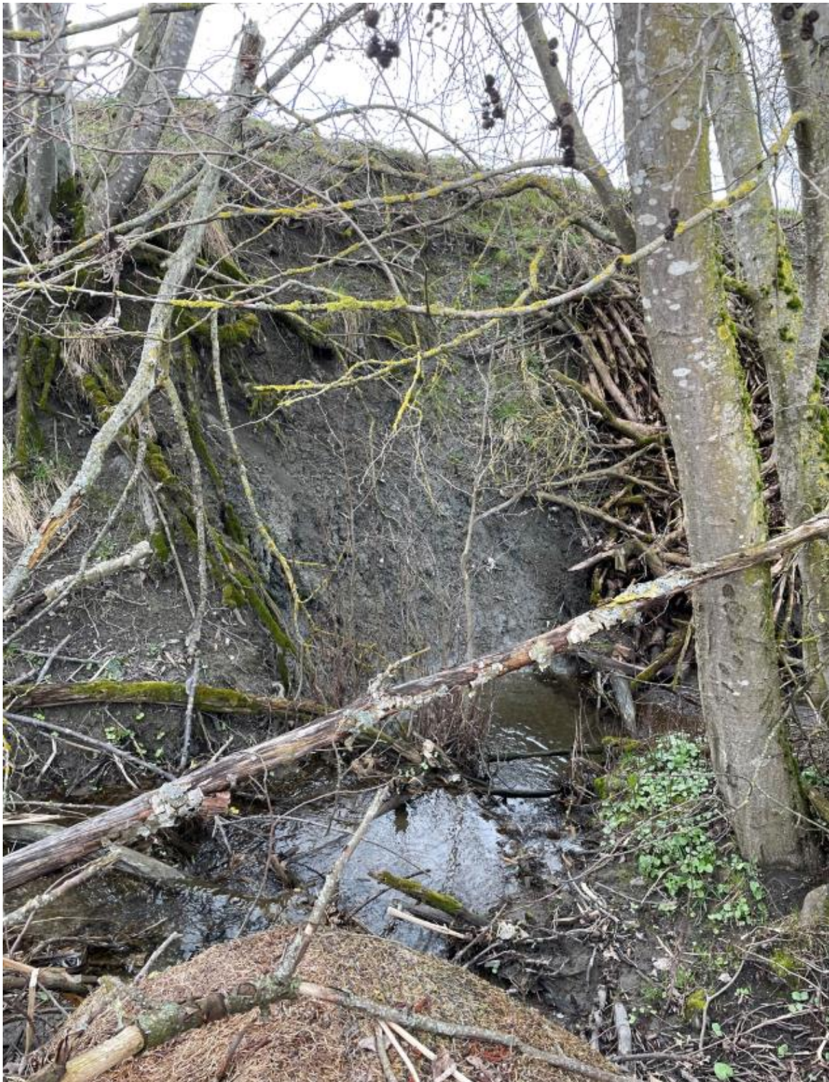
Figur 10: Bilde fra lokasjon 5 markert i figur 1. Noe erosjon på sørside av ravine, i form av overflateutglidning med eksponert silt/leire.
