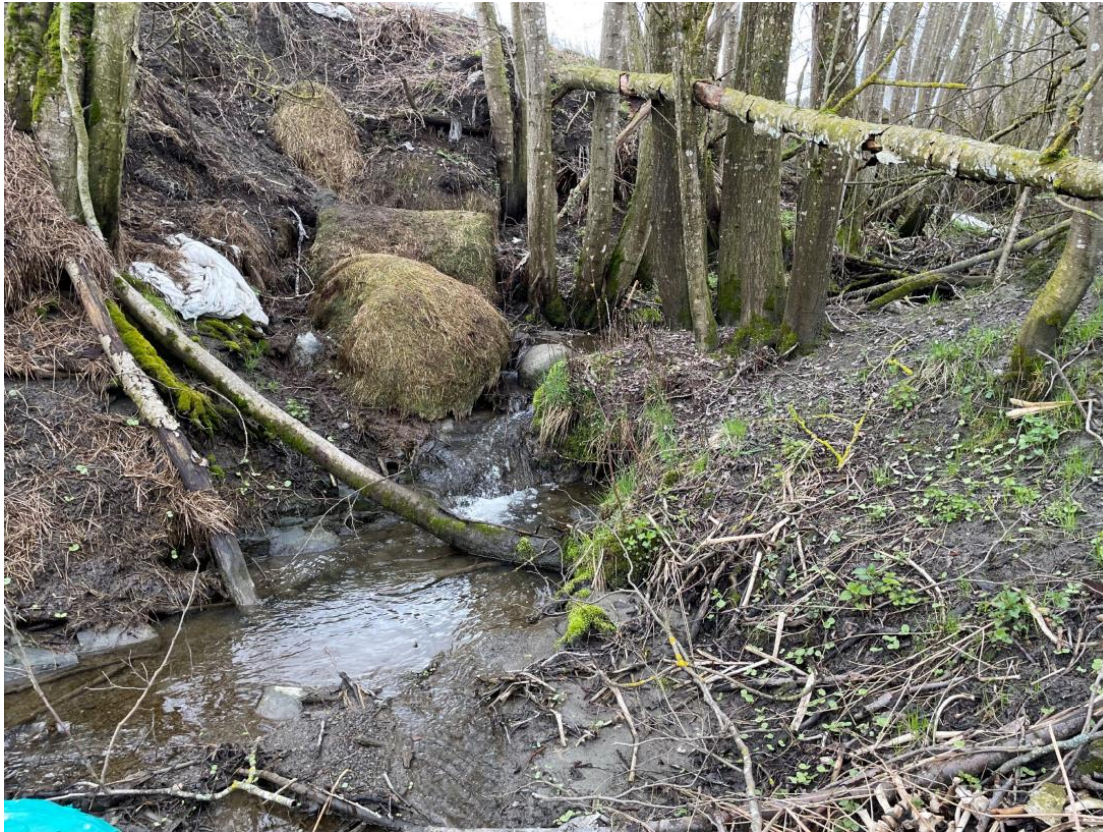
Figur 8: Bilde fra lokasjon 4 markert i figur 1. Noe erosjon.
