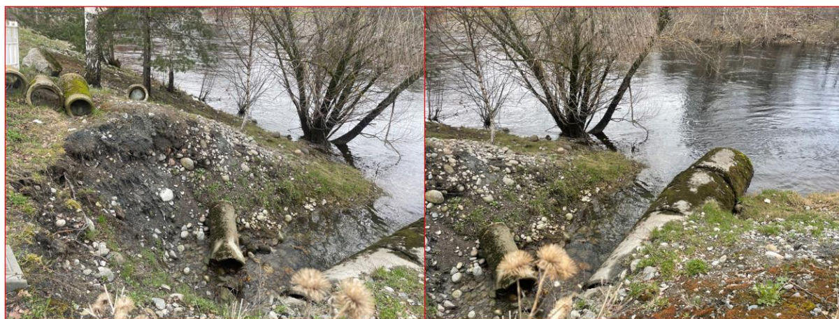
Figur 32: Rør med utløp i Vestfosselva. Lokasjon 2 på figur 30. Sår i terreng, litt erosjon.
