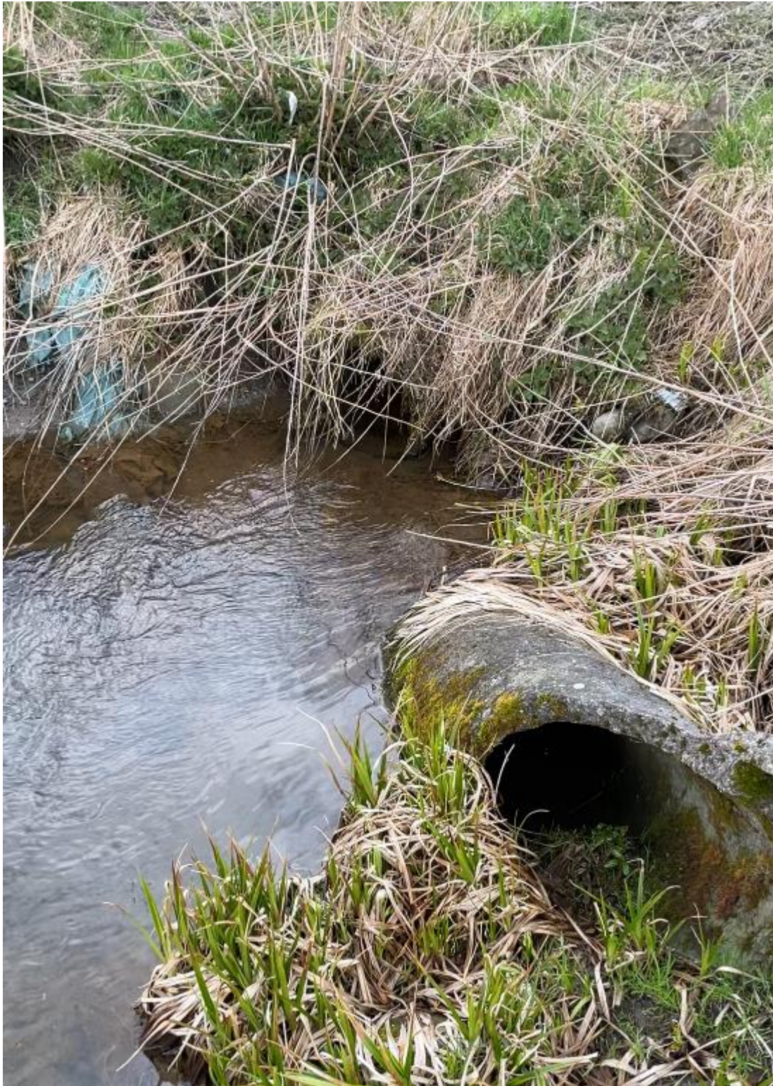
Figur 12: Bilde fra lokasjon 7 markert i figur 1. Bekkeutløp, rør skjult under vegetasjon og knekt rør uten gjennomstrømming.
