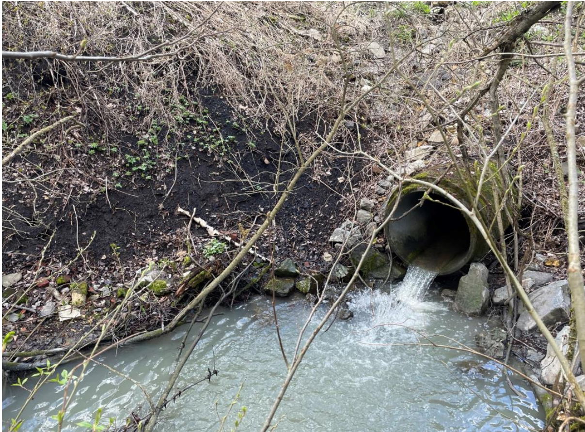
Figur 21: Bilde fra lokasjon 5 markert i figur 14. Plastring ved utløpsrør, vurderes ikke å være i forbindelse med erosjonssikring. Uklart vann. Noe erosjon.
