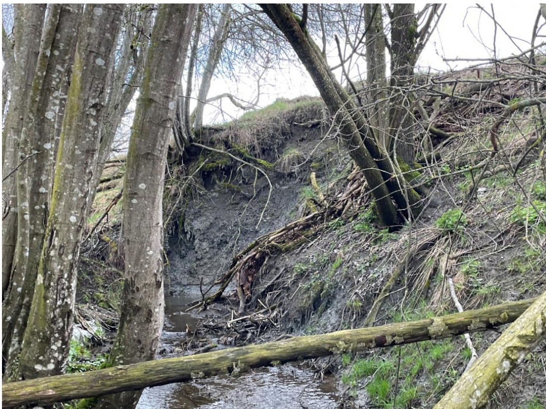
Figur 9: Bilde fra lokasjon 5 markert i figur 1. Noe erosjon på sørside av ravine, i form av overflateutglidning med eksponert silt/leire.
