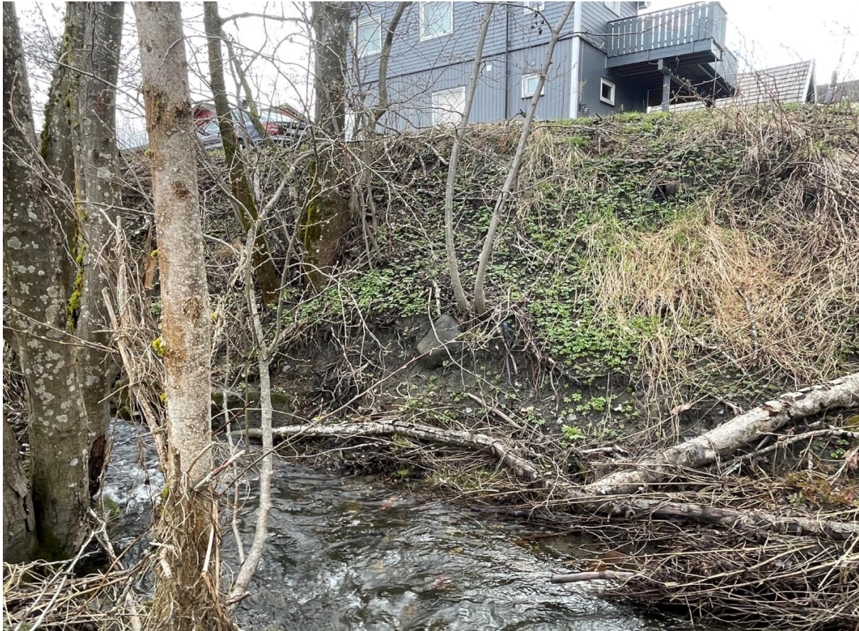
Figur 29: Langs bekk ved Fabrikkgata, observert fra vestsida av bekken (lokasjon 4 på figur 25). Sår i terrenget. Litt erosjon.
