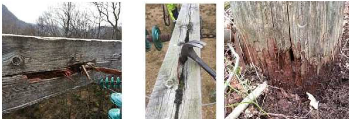
Figur 2-2. Råteskader og oppsprekking på traverser og master.
