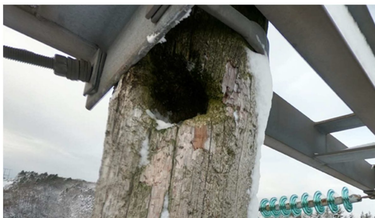
Figur 2-3. Eksempel på hakkespetthull i tremast.
