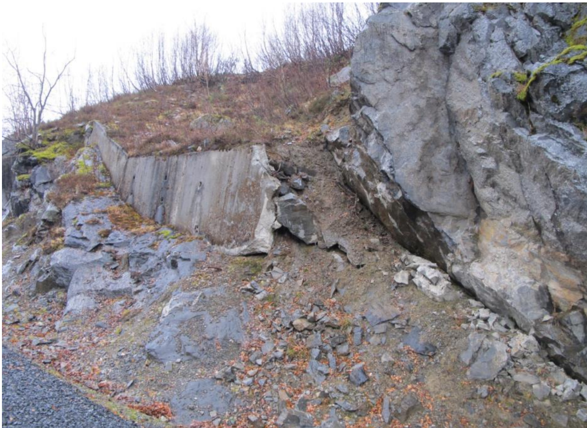
Figur 2-82 Her trengs det utbedring av erosjonsskader. Dette er fra veien ned til tverrslaget i Gryddalen.
