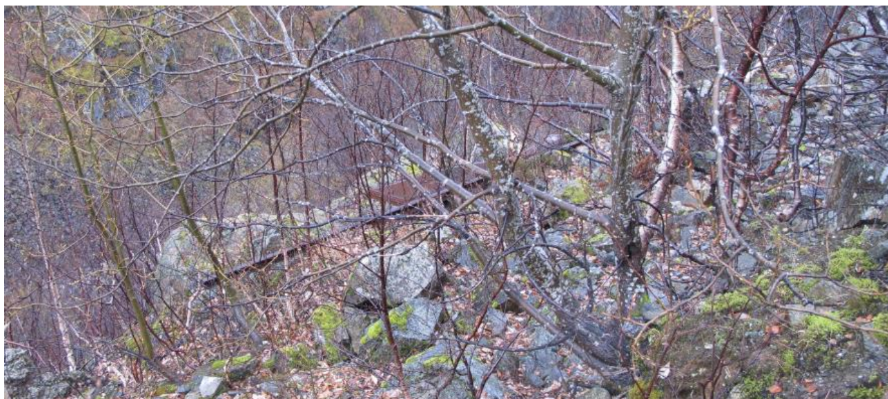
Figur 2-81 Opprydding av stål, plast og annet skrot som ligger igjen på tippene. Gryddalen
