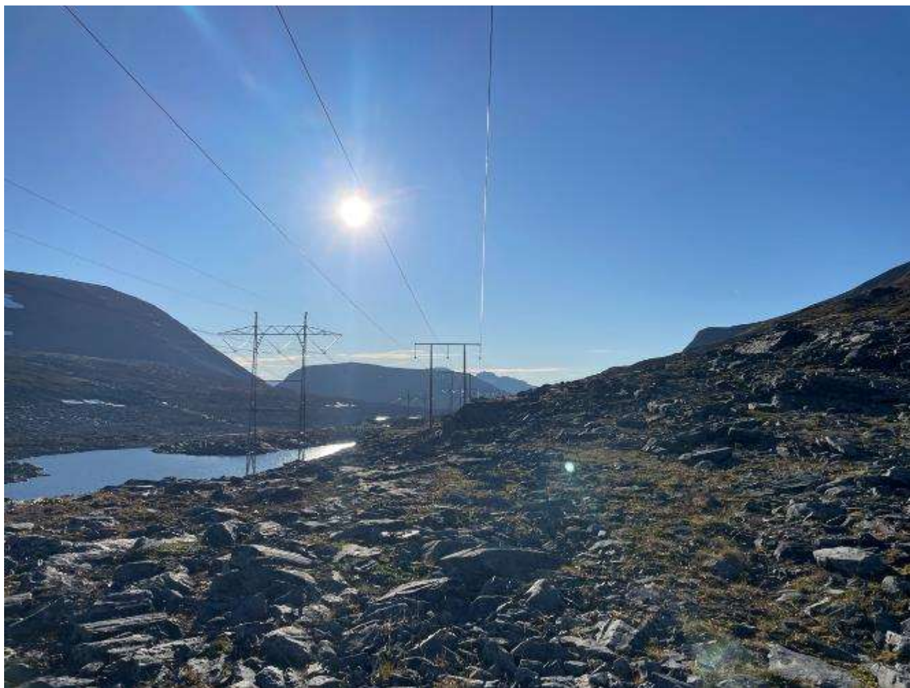
Spenn 57-58 mot mast 58
