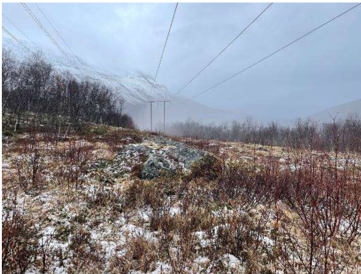
Spenn 108-109 mot mast 109
