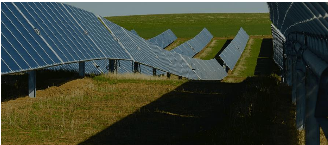
Figur 3-1 En-akse tracker installasjonsløsning (foto: Nextracker).
