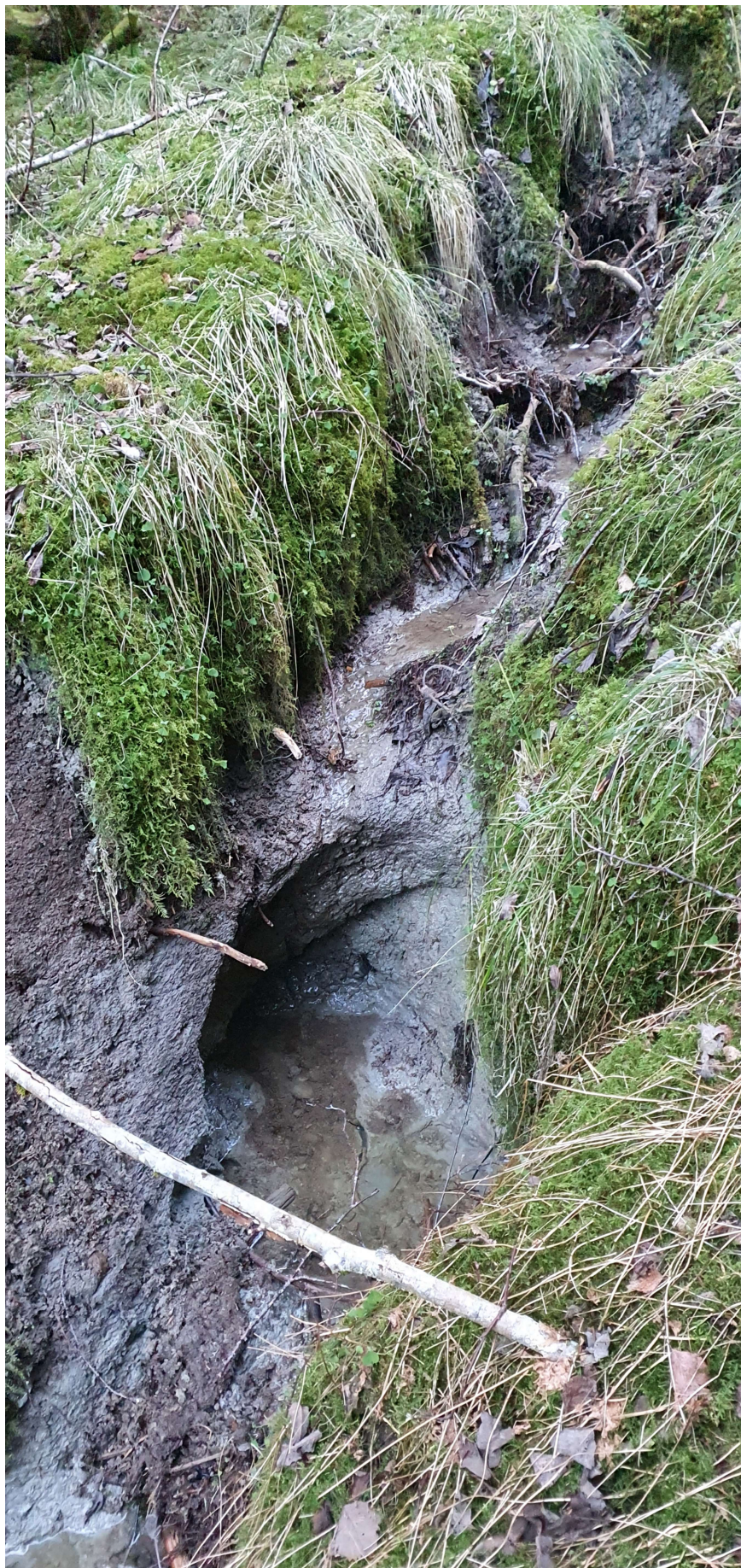
Figur 13: Et lite dropp som har medført noe erosjon i bekkeløpet. Synlig leire i bekken.
