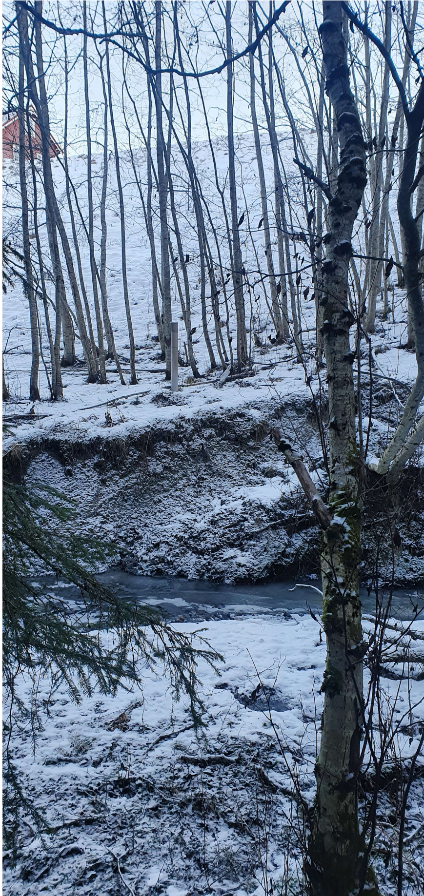
Figur 20: Skredkant etter en tidligere utrasning langs Holemsbekken.
