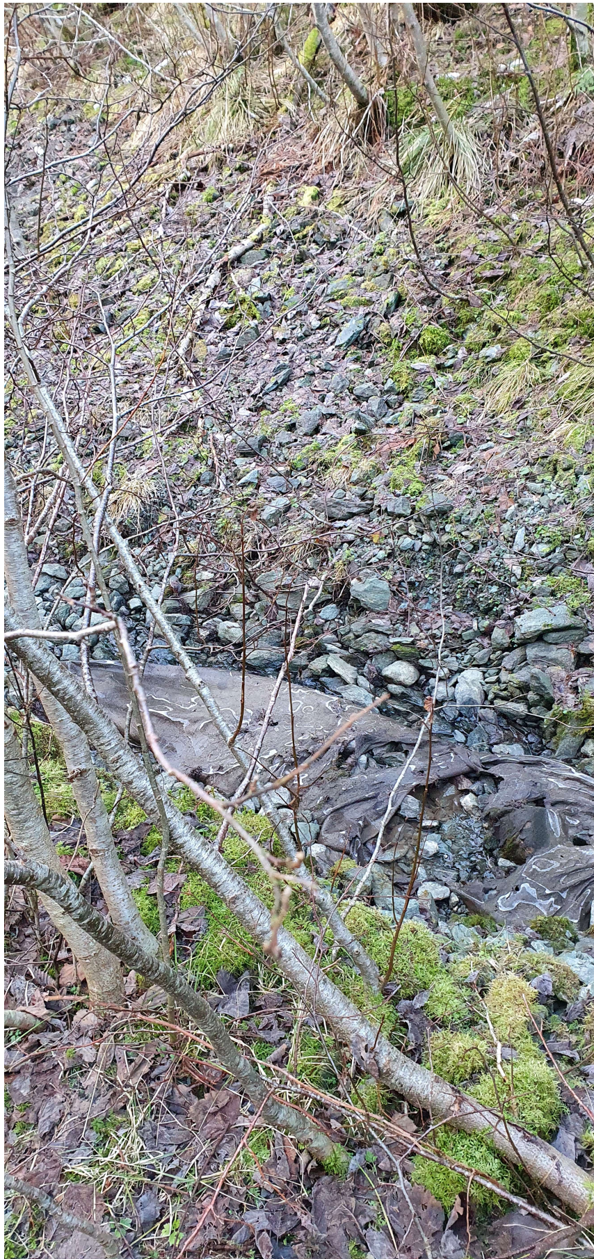
Figur 14: Erosjonssikret bekk. Geotekstilet har blitt presset opp trolig som følge av tele, men erosjonssikringen antas å ha opprettholdt sin funksjon.
