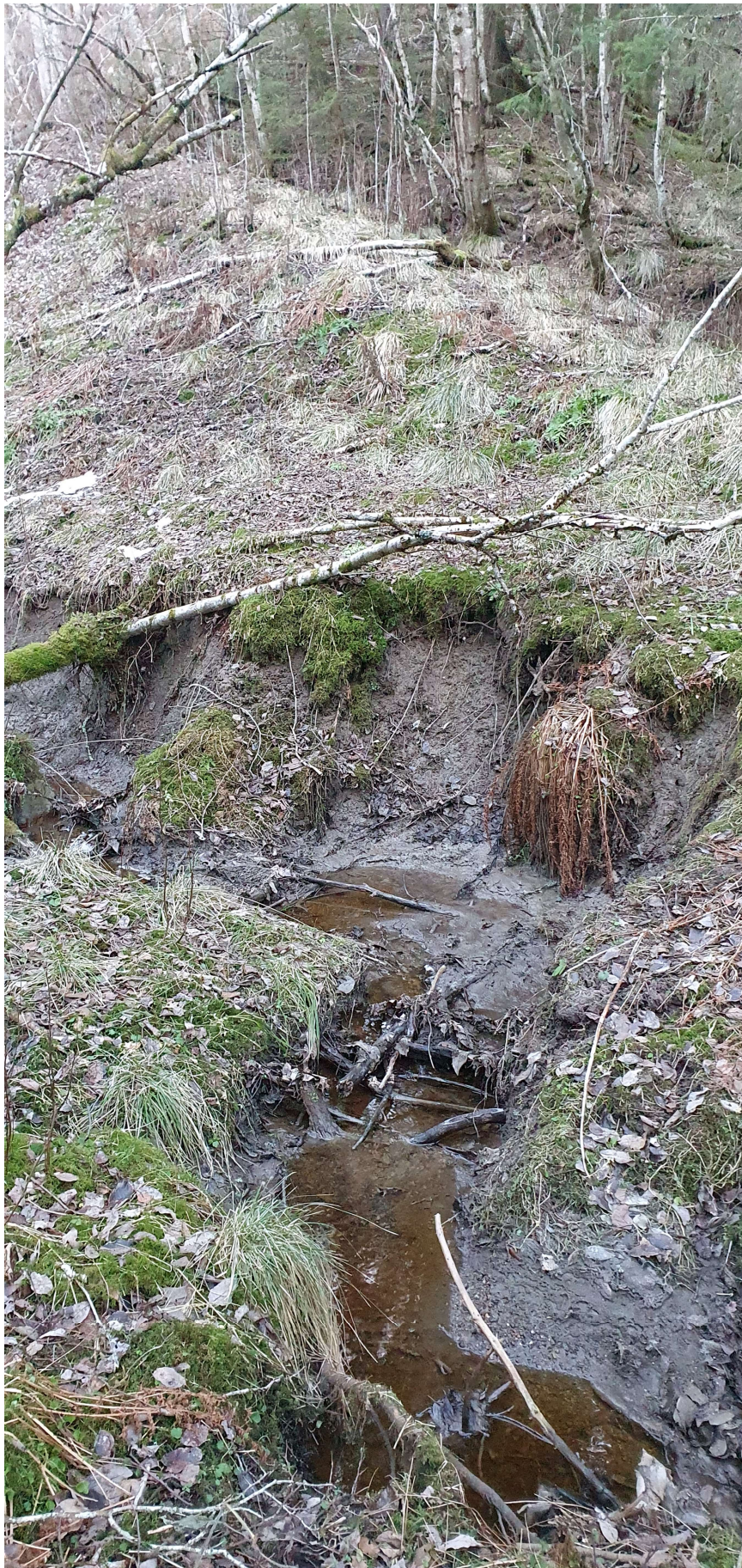
Figur 7: Synlige skredkanter etter mindre utglidninger. Gjentakende observasjon langs hele bekken.
