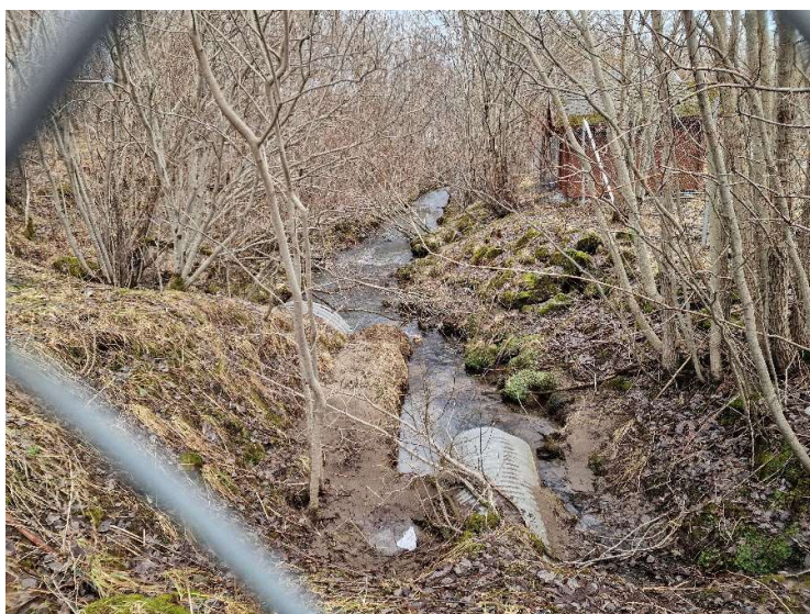
Bilde 3-6 , Utløp av de stotre korrugerte stålrørne til elv ved Idrettsbane.
