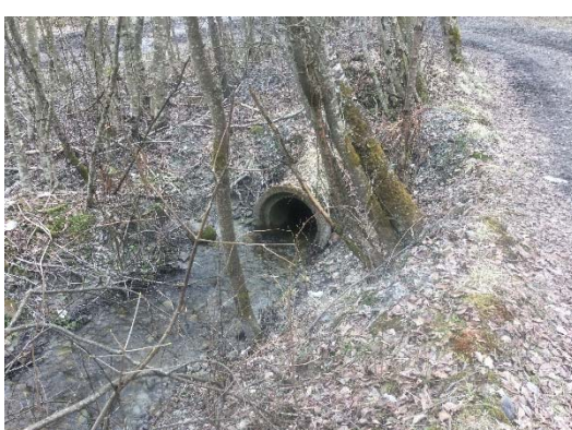
Figur B6: Ingen erosjon mot stikkrenne under jernbanefylling. Bekken går i rør.
