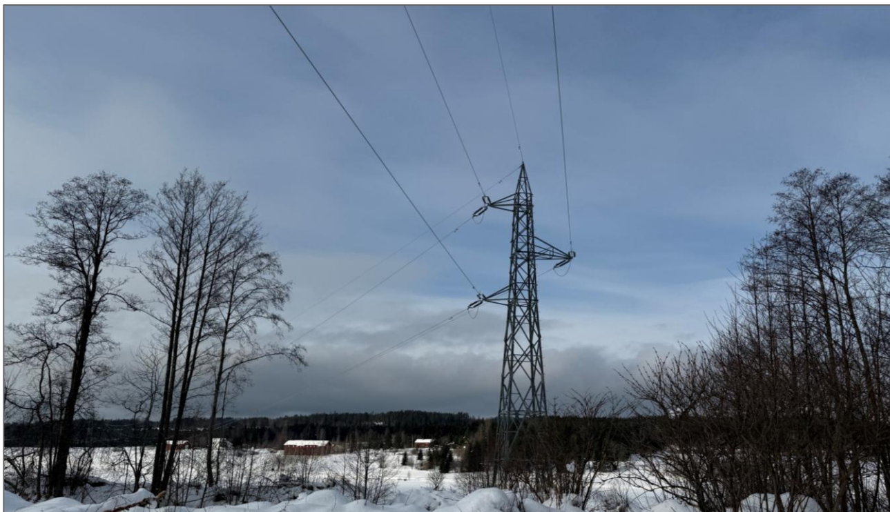
Figur 5: Den eksisterende 66 kV Flesaker-Stengelsrud med mastepunkt ved elva Dørja. Den tynnere topplina ligger øverst i masta, og er mindre synlig enn de tre planene med tykkere faseledere under (Foto: Håkon Gregersen).
