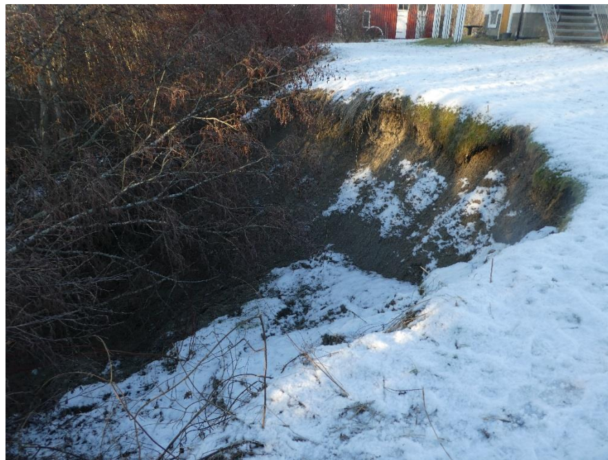
Bilde 5: Rasgropa inne i hagen til tomannsboligen. Distansen fra raskanten til huset er ca. 10 meter.
