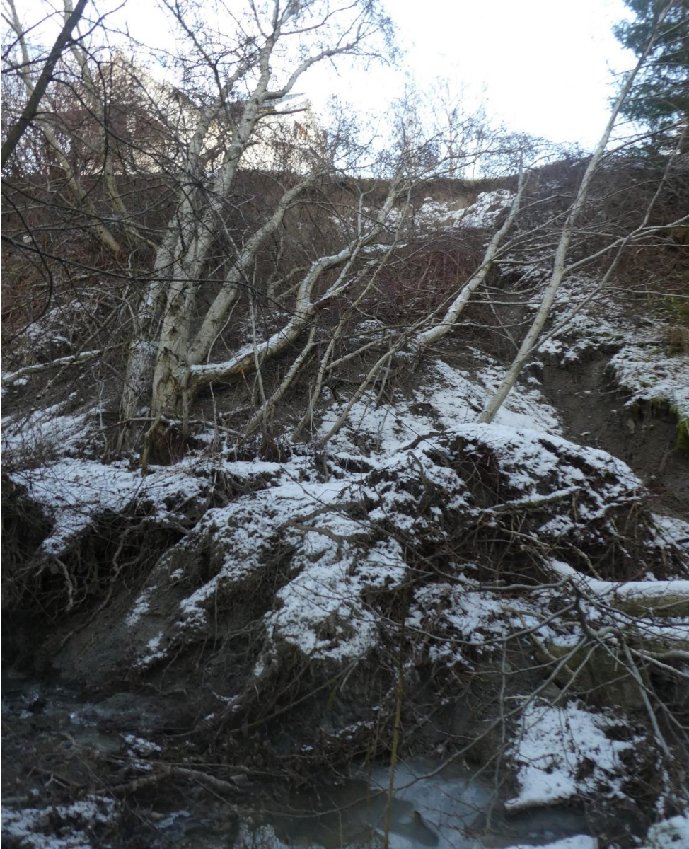
Bilde 1: Rasgropa fra raset i desember 2016, sett nedenfra. Man kan observere blottet leire og trær som har falt over. Legg merke til huset bak raskanten oppe til venstre. Det er omtrent sju meter høydeforskjell fra topp til bunn.
