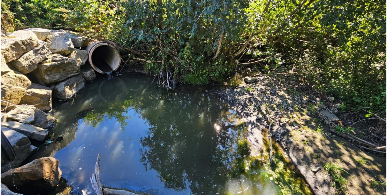
Figur 4-4 Kulvert ved traktorkryssing, tydelig begroing i den lille dammen som er formet i utløpet. Trådalger henger ut av kulverten. Svært lite vann på befaring, knapt med vann som kommer ut av kulverten.
