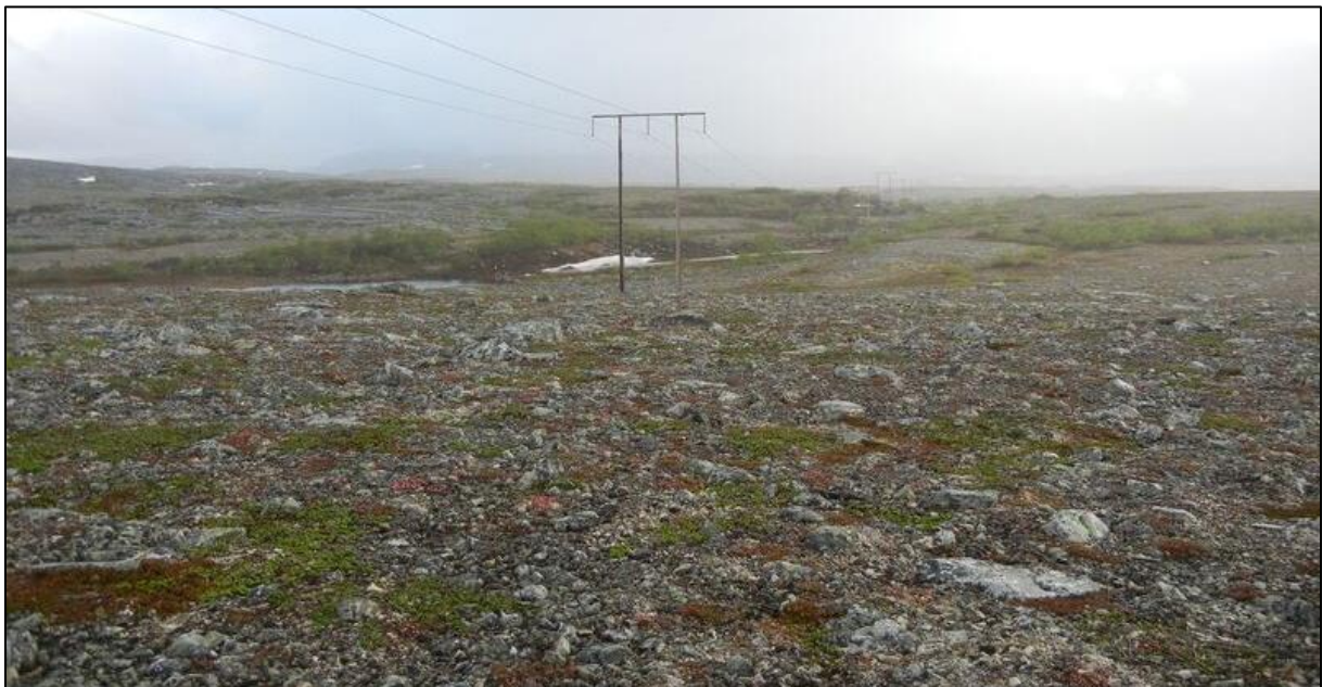
Bilde 8. Eksisterende 132 kV-kraftlinje ved Storelva like sør for Fv 98.
