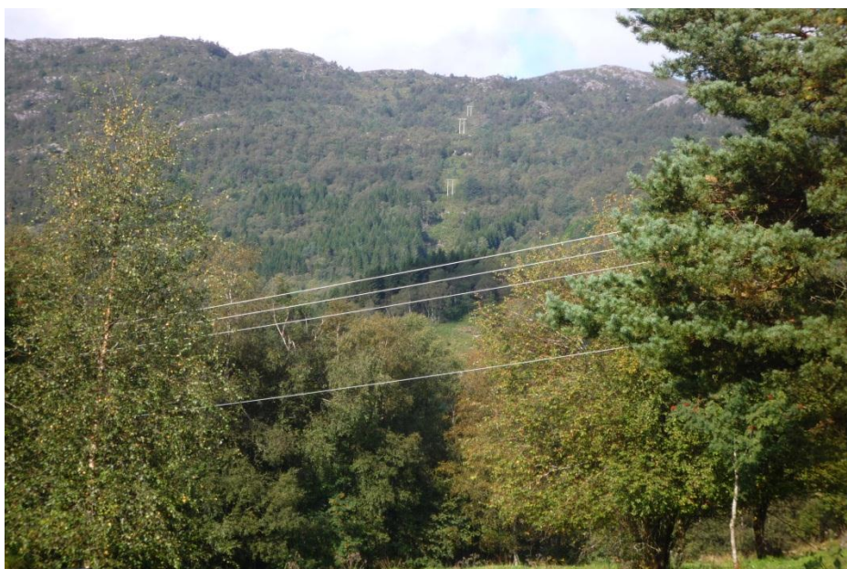
Figur 10. Bak i bildet ser man eksisterende ledningsnett gå fra heiarealene i planområdet til nedenforliggende skogområder øst for planområdet. Foran i bildet har ledningsnettet endret retning mot trafostasjonen i Ølen.
