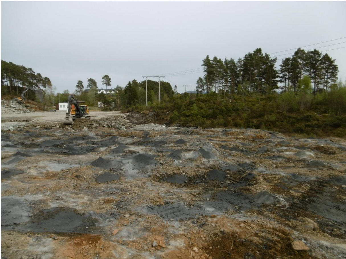
Bilde 1; eksisterende luftlinje nedover mot Vabakken transformatorstasjon
