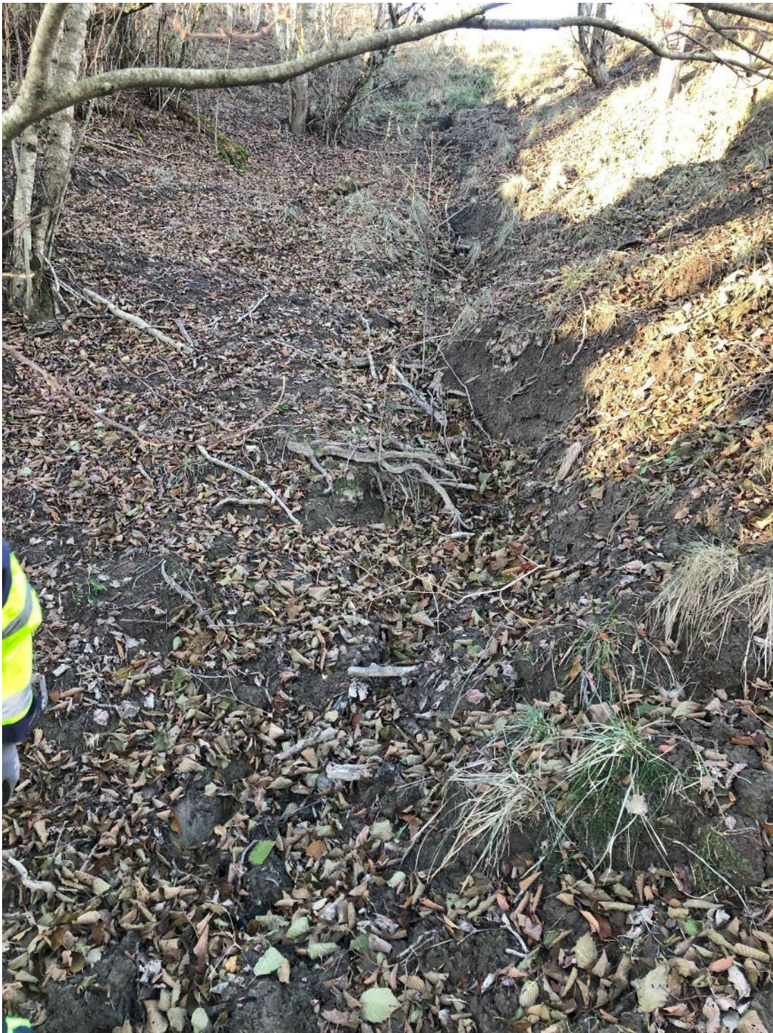
Figur 12 Erosjon i skråning over tiltaket
