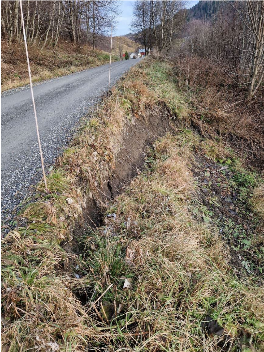
Figur 17 Utglidning og erosjon i skråninger
