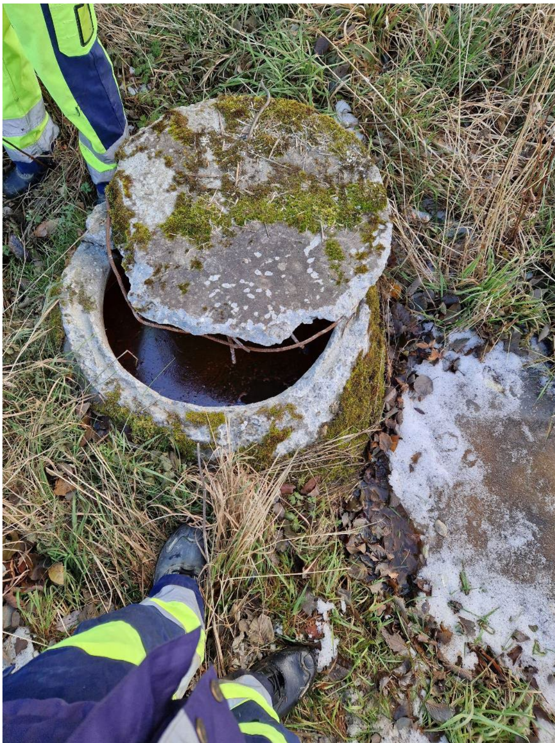
Figur 19 Overvannshåndtering, tett kum på toppen av skråning. Når drens og overvannshåndtering ikke fungerer vil vann infiltrere inn i skråningen som fører til økt poretrykk og svekket skråningsstabilitet. Overvannshåndteringen anbefales utbedret.
