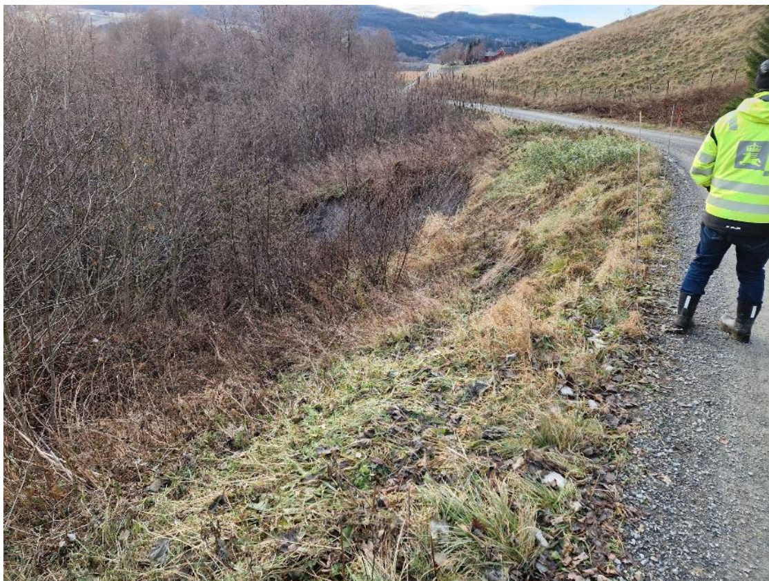
Figur 14 Utglidning og erosjon i skråninger. Raset som ble rapportert inn 20. oktober 2023. Raset ser likt ut som på bilder fra innrapporteringen.
