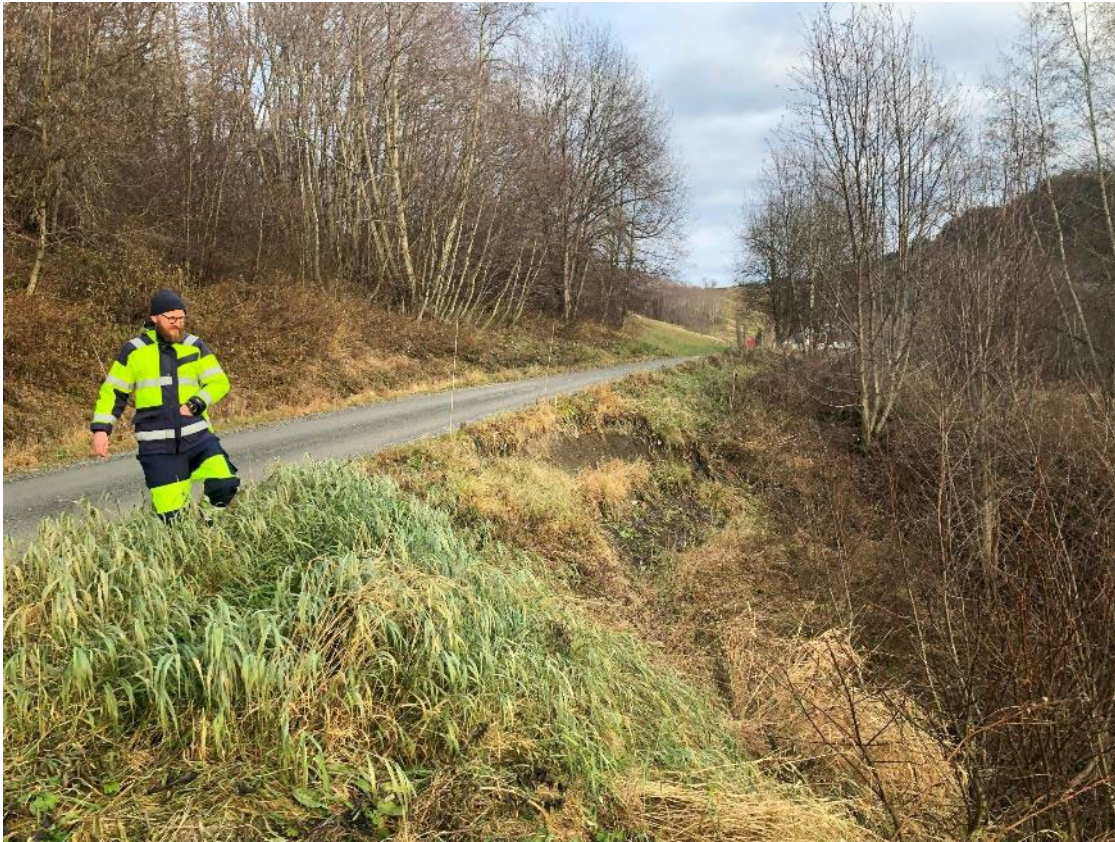
Figur 16 Utglidning i skråning
