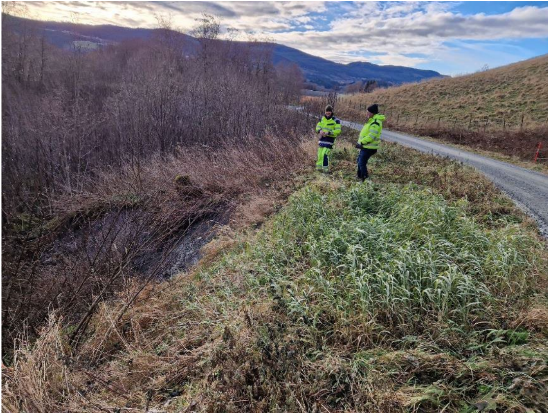
Figur 15 Utglidning og erosjon i skråningen der rashendelsen i 2023 fant sted.
