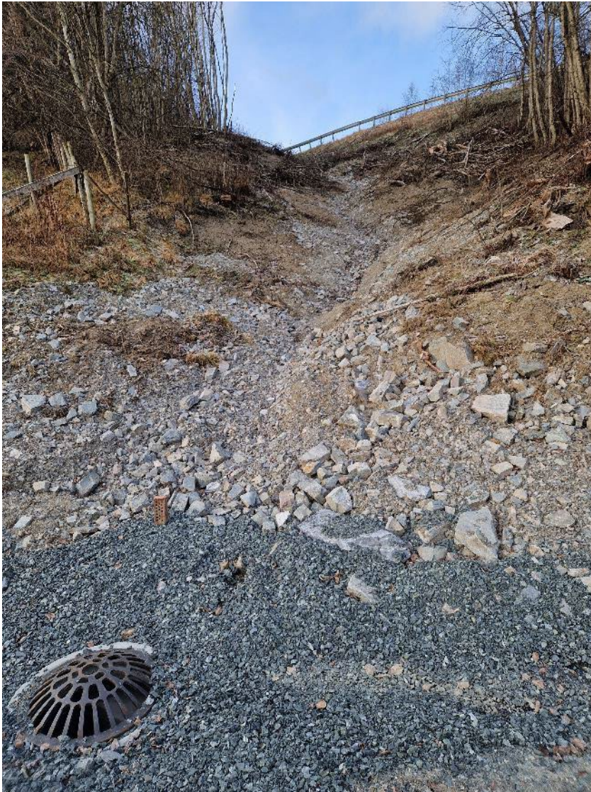
Figur 134 Erosjonssikret sideravine og ny kumme
