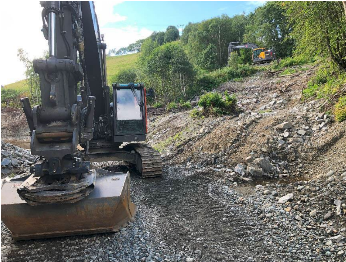
Figur 97 Skredhendelse sikret med motfylling, høyre del av bildet
