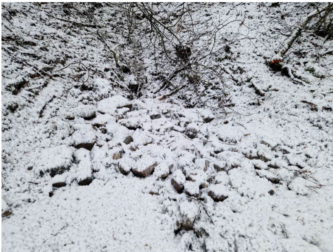
Figur 53 Visuell inspeksjon tyder på mangel av 0-fraksjon eller "grus-pute" i sikring under motfylling i sideraviner
