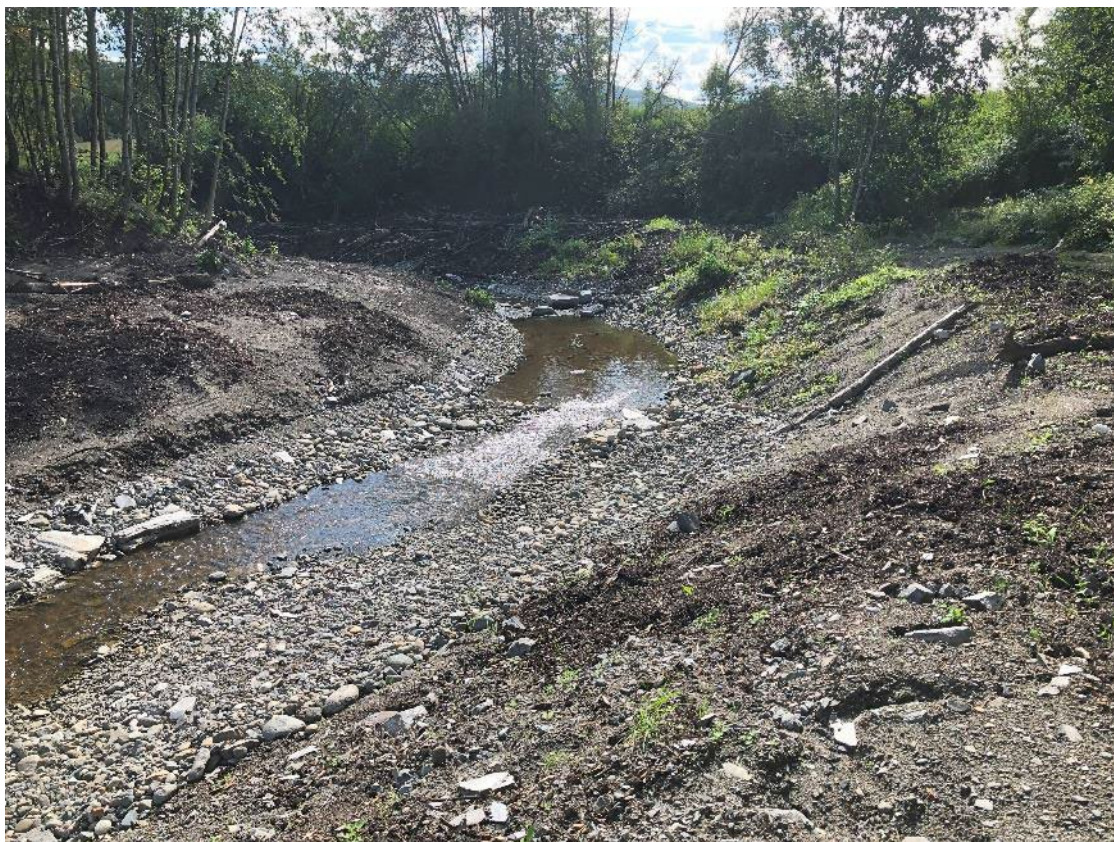
Figur 90 Erosjonssikring, bilde tatt i retning nedstrøms
