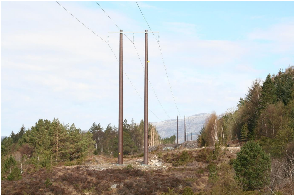
Foto: 132 kV Bæremast
