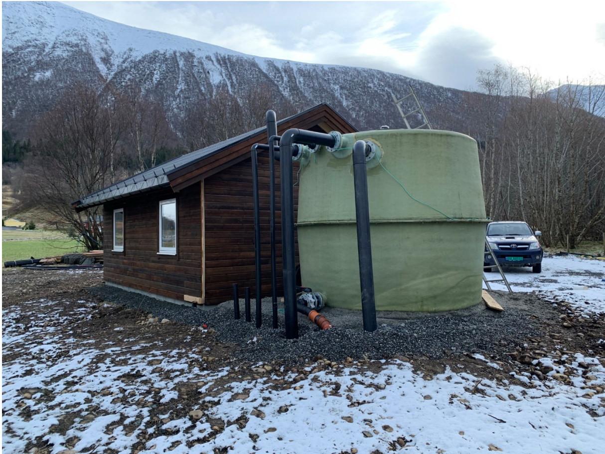
Figur 7. Tank og pumpehus ved B5.
