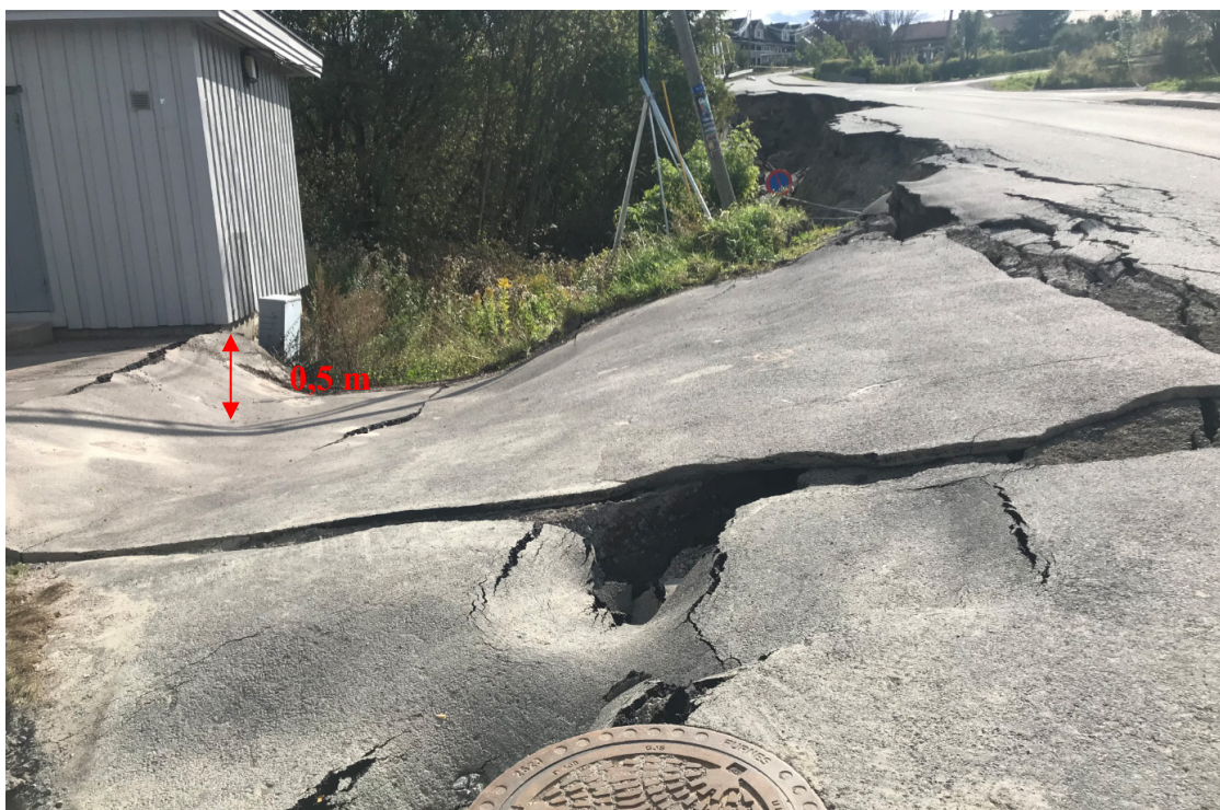
Figur 4 viser et bilde tatt den 18. september 2019 av NGI. Terrenget i forgrunnen av bildet, mellom (eksisterende) pumpehus og (tidligere) fotgjengerfelt sank plutselig sammen i løpet av 17. september 2019.
