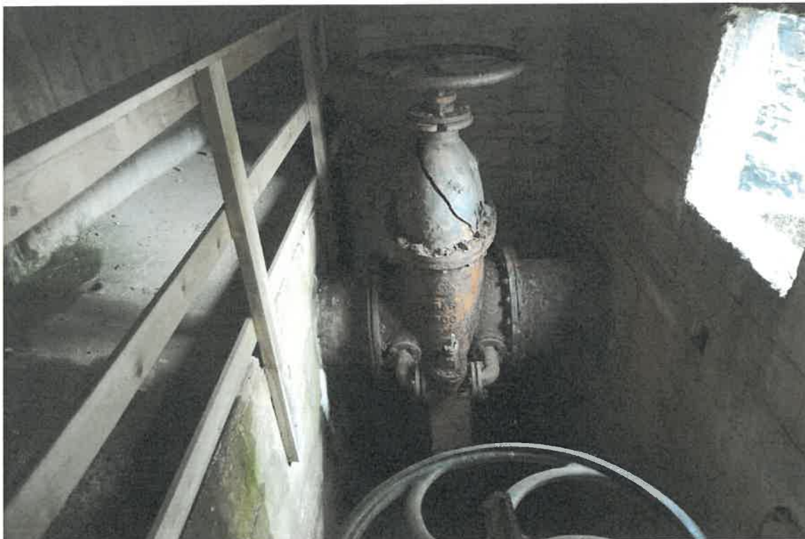
Bilde 6 Det står gamle tappeventiler og tapperør inne i dammen. Dette må leveres inn som skrapjern.
