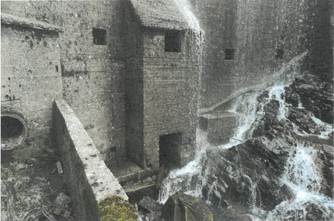
Bilde 4 Betongdam luftside. Det er isolasjonsveggen som er synlig. Selve dammen ligger oppstrøms denne. Det er rester av jernrør og gamle ventiler inne i dammen.
