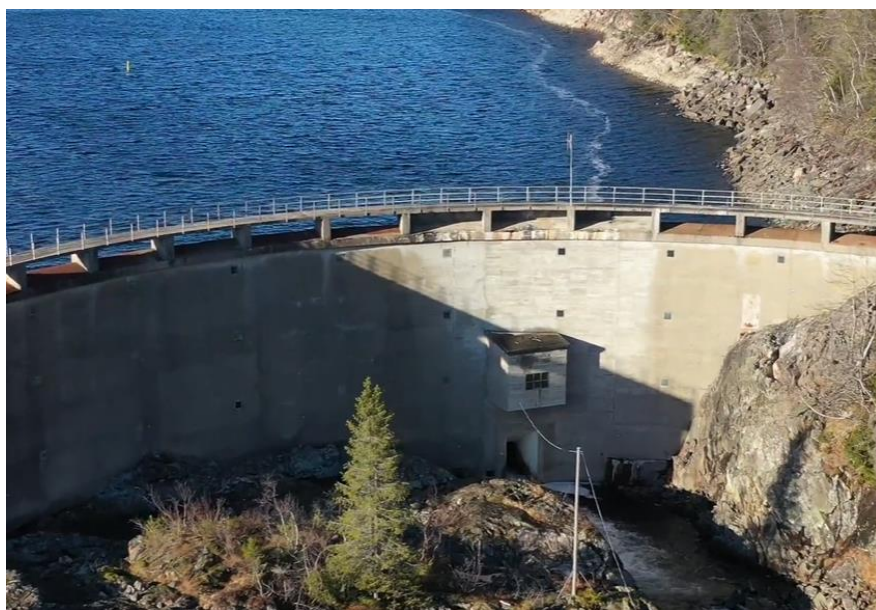
Figur 10. Slipp av minstevann fra dam Borsæ foregår via dykket luke. Graden av dykking avhenger i stor grad av magasinfyllingen.
