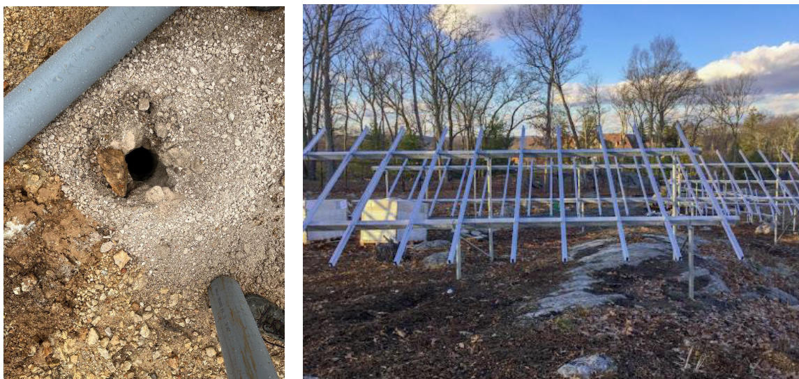
Figur 9: Eksempel på montasjestruktur fundamentert i fjellgrunn (c) Greenstat Solar Solutions
