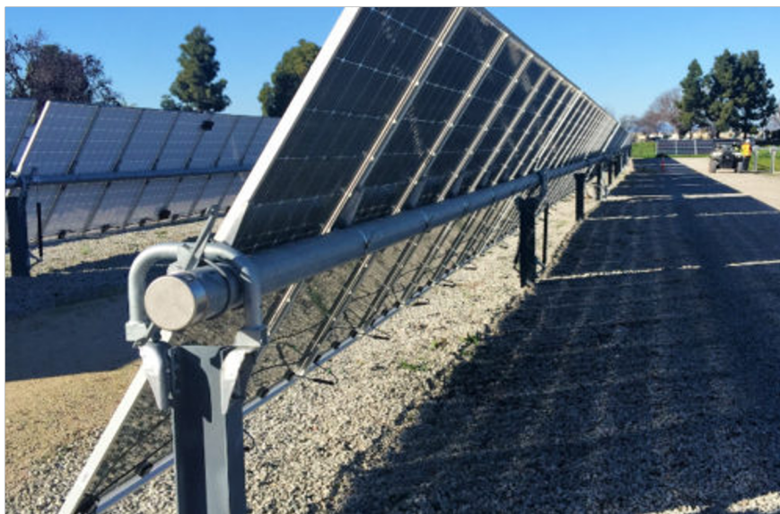
Figur 8: Eksempel på en-akse rotasjonsinstallasjon med dobbeltsidige (bi-facial) paneler
