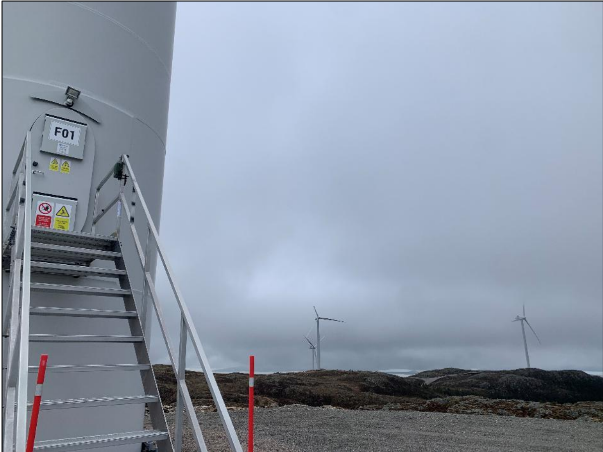
Figur 3.1. Bildet viser en SM 4 BAT FS detektor montert på rekkverket av en turbin i Hitra vindkraftverk. Foto: Runa Odden.
